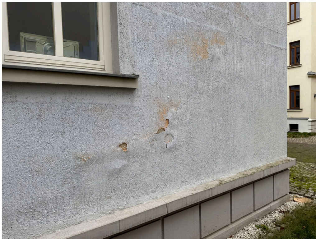
Schäden an der Nordfassade des Hinterhauses
