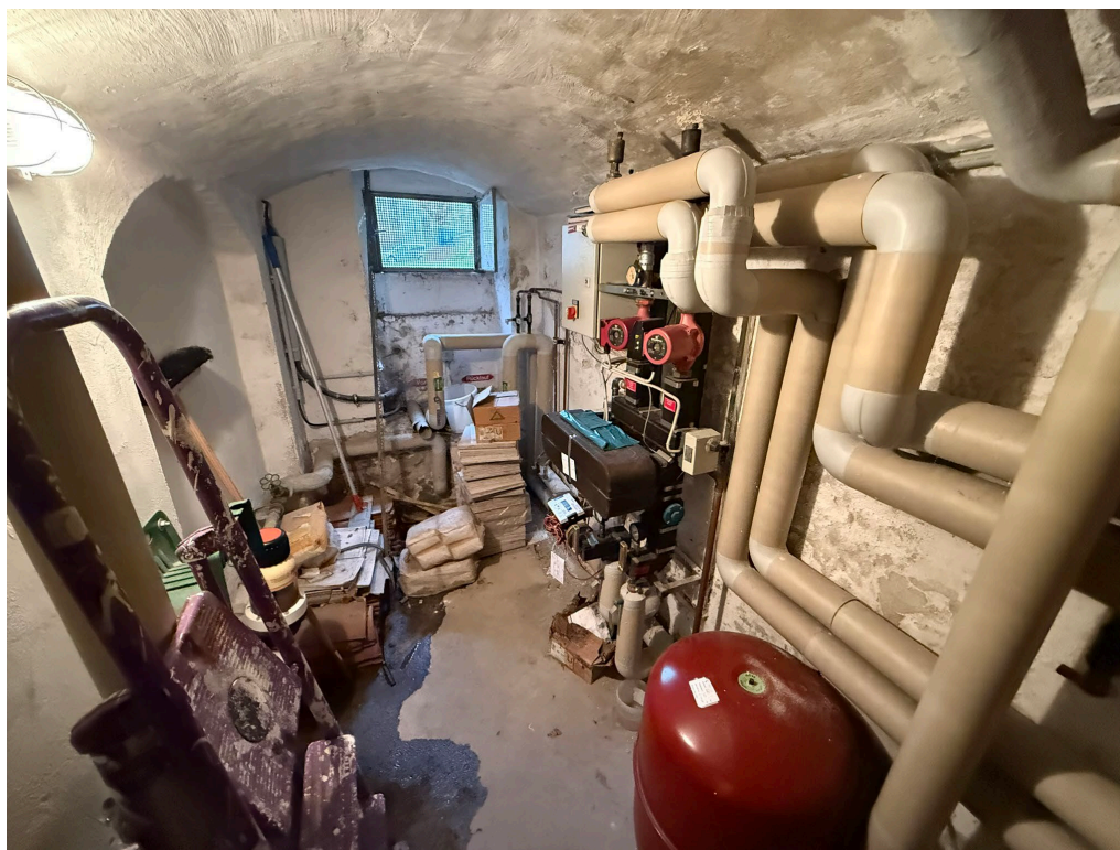
Heizungsraum (Fernwärmeübergabestation) im Kellergeschoss
