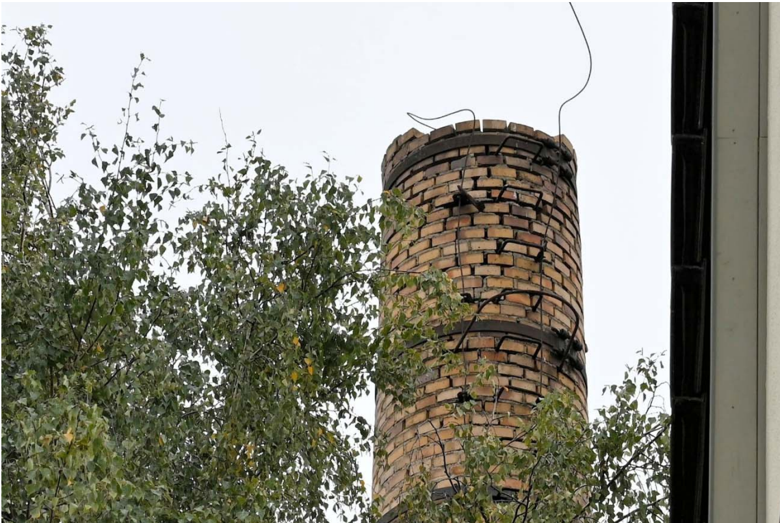
Abb. 7: Industrieschornstein, Kopf stark verwittert
