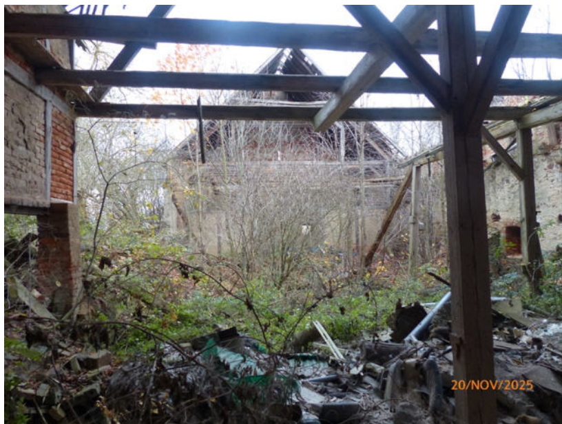
Fotos 69, 70 und 71: Blick in die Scheune – Mittelteil des Daches und hintere Fassade eingestürzt - vermüllte Bereiche auf der Süd- und Nordseite
