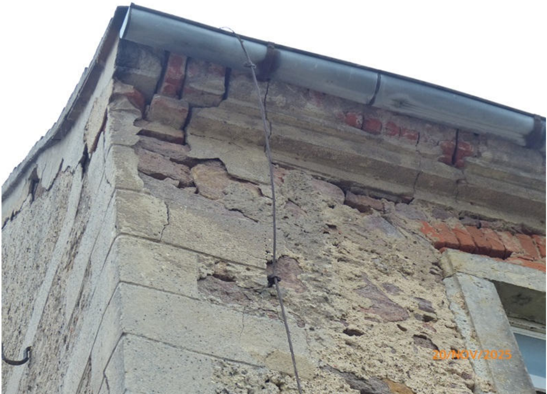
(Nordostecke – baufälliges Mauerwerk im Anschlussbereich Giebel/Traufe)
