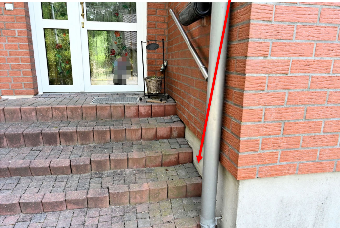
Abb. 8: Am Mokkaberg 3, Hauseingangstreppe, Detail Setzungen
