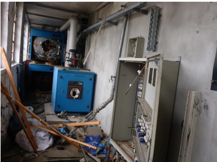
Gebäude 1, Halle 4 Technikraum
