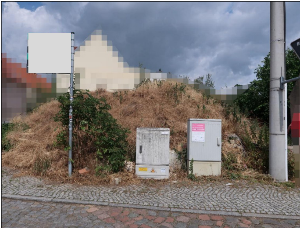
Bild 4: Medienverteilerkästen im öffentlichen Bereich am Flst. 202
