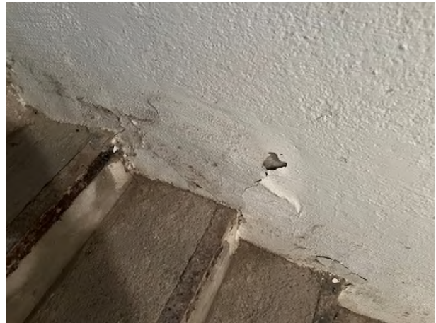
Nässeschäden an der Kellertreppe
