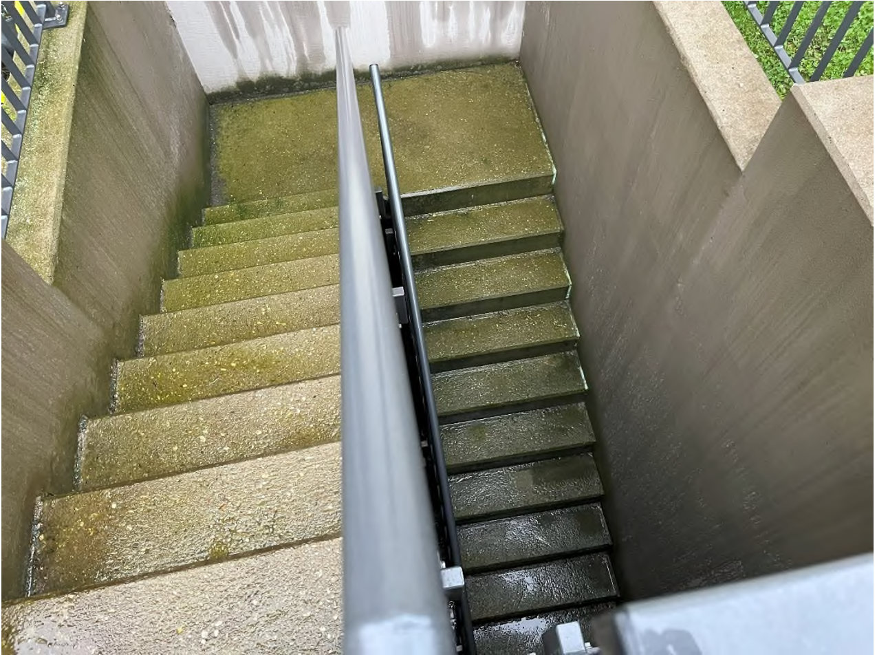
Fluchwegtreppe aus der TG ohne Dach
