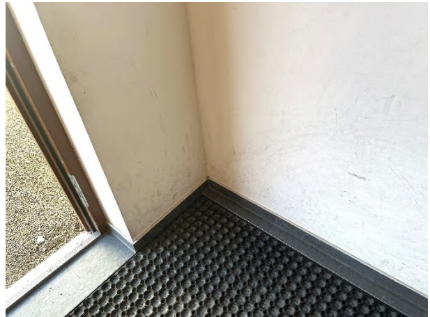
Gebrauchsspuren im Treppenhaus
