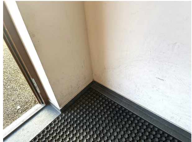
Gebrauchsspuren im Treppenhaus
