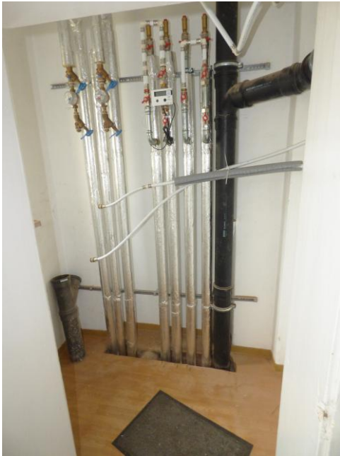
Bild 25: wie vor, hier im Bereich zwischen 1. und 2. Obergeschoss
