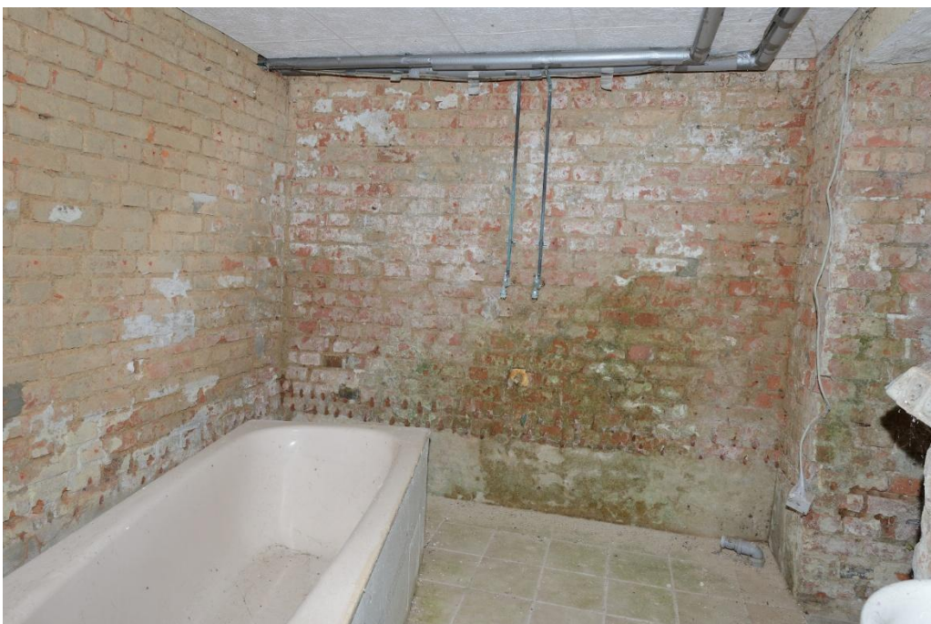
ehemaliges Bad im Keller / tlw. erhebliche Feuchtigkeitsschäden
