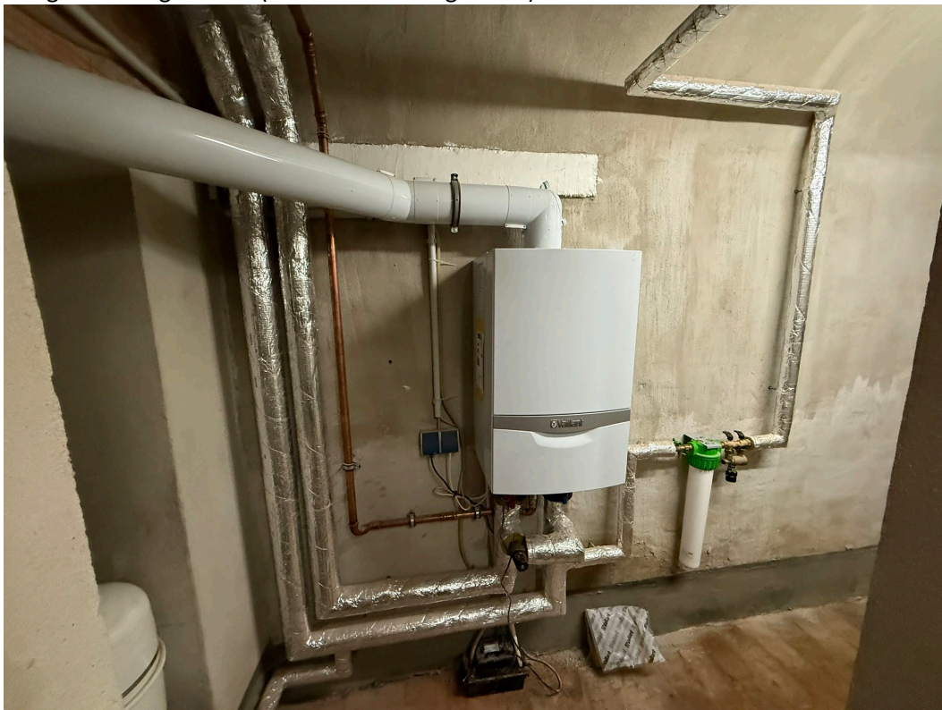
Heizungsraum im Kellergeschoss (Gemeinschaftseigentum)
