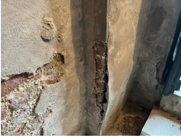
Gemeinschaftseigentum Putzabplatzungen im Keller
