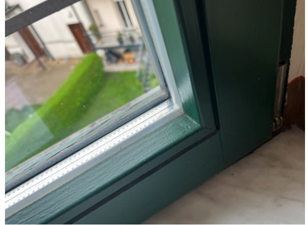
Gemeinschaftseigentum Wetterschenkel mit Witterungsschäden
