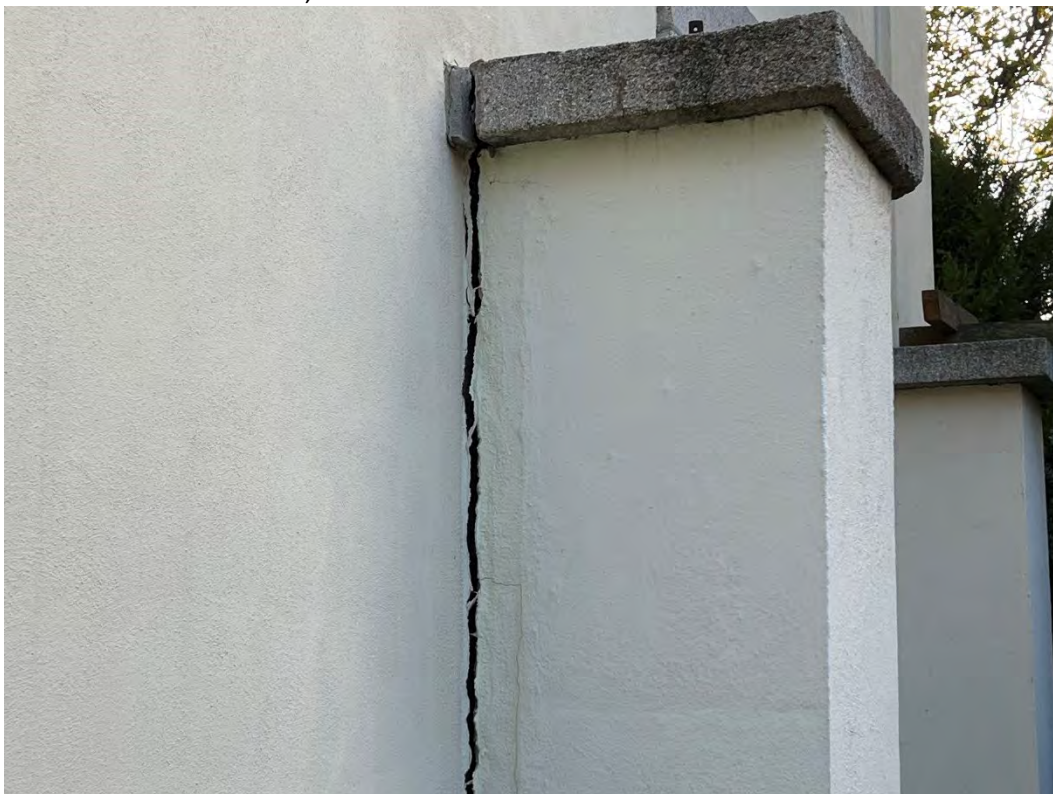
von der Außenwand abgerissener Mauerpfeiler des Brunnenhofs
