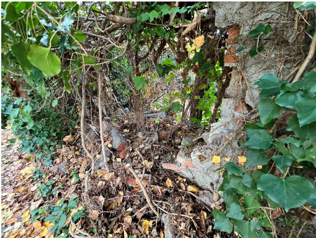
eingestürzter Mauerbereich an der östlichen Grundstücksgrenze
