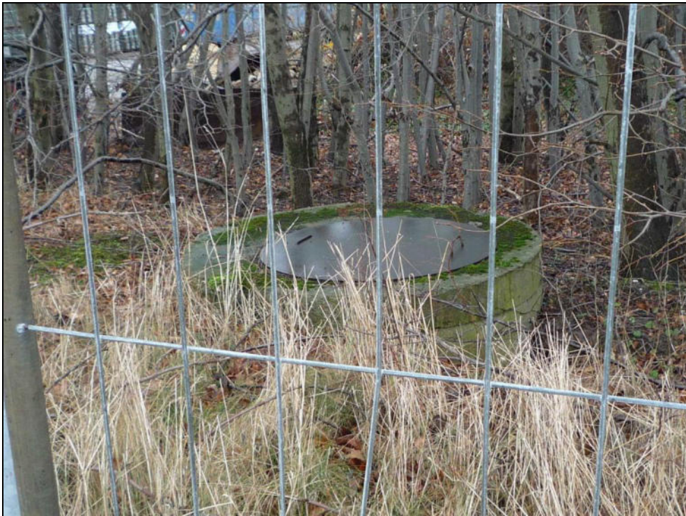
Bild 26: Übergabeschacht an der Oberen Dorfstraße / ehem. Wasseranschluss
