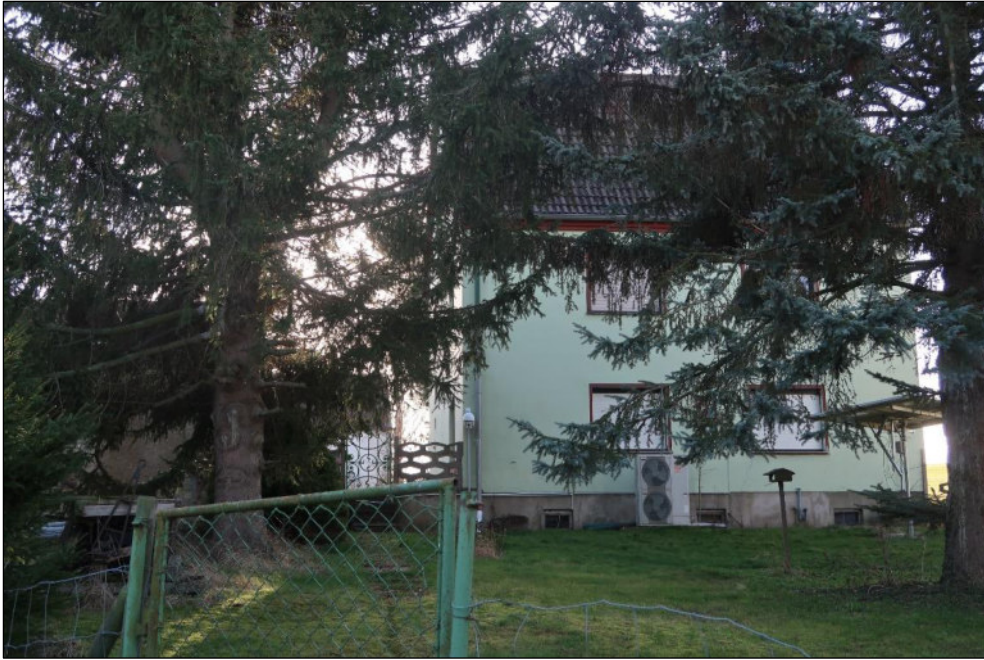
Bild 11: nordwestliche Längsseite des Wohngebäudes / Detailansicht Luftwärmepumpe
