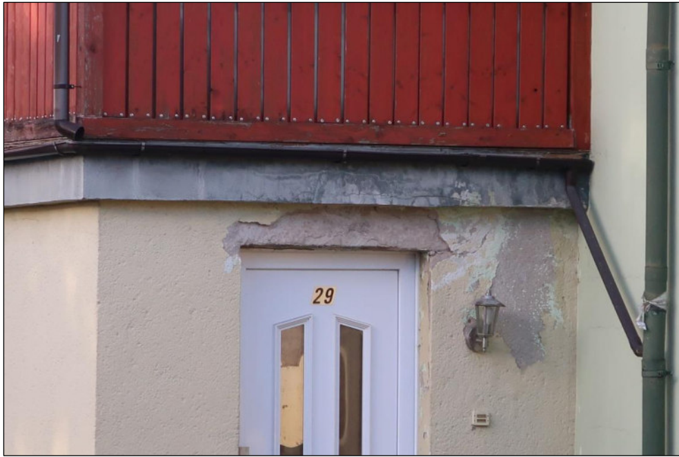
Bild 5: Hauseingangsbereich mit Nässeschaden an Mauerwerk/Außenputz
