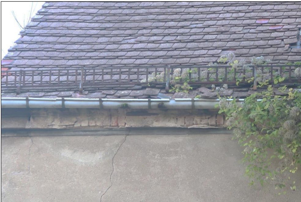
Bild 6: Detailansicht des beschädigten Daches und Traufgesimses (südwestliche Gebäudeecke)
