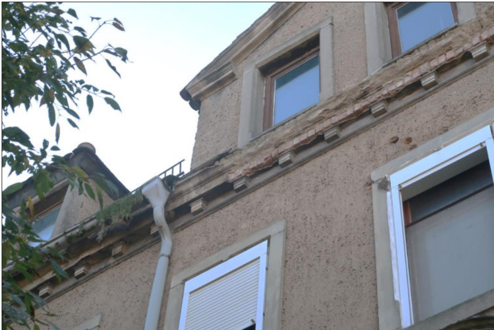
Bild 2: Detailansicht der Schäden am nördlichen Traufgesims
