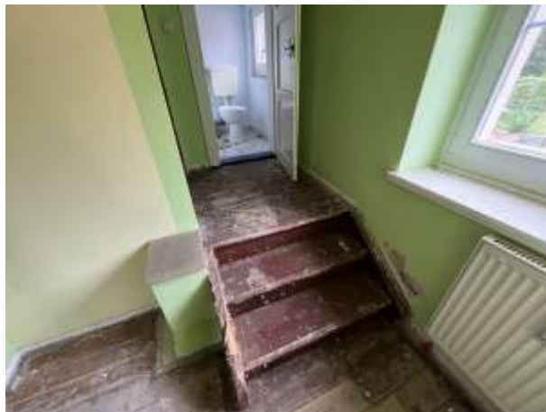
Foto 22: Treppenversatz im Flur
