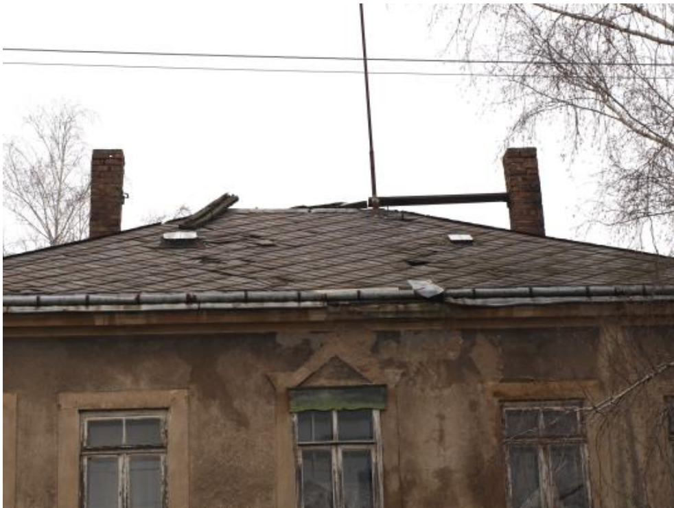
Abbildung 11: desolater Zustand der Dacheindeckung und Entwässerung, u.a. größere Lösser in der Dacheindeckung, defekte Dachrinnen und herabgefallenes Trittbrett (Laufsteg) aus Holz für die Schornsteinreinigung (oben links)
