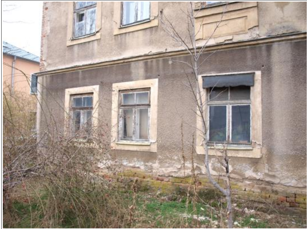
Abbildung 12: desolater, straßenseitiger Gesamtzustand, u.a. Fenster, Fassade, Sockel
