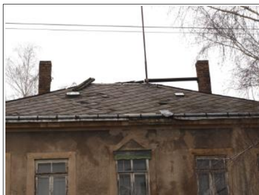
desolater Zustand der Dacheindeckung und Entwässerung, Löcher in der Dacheinde- ckung, defekte Dachrinnen und herabgefall- enes Trittbrett (Laufsteg, oben links)
