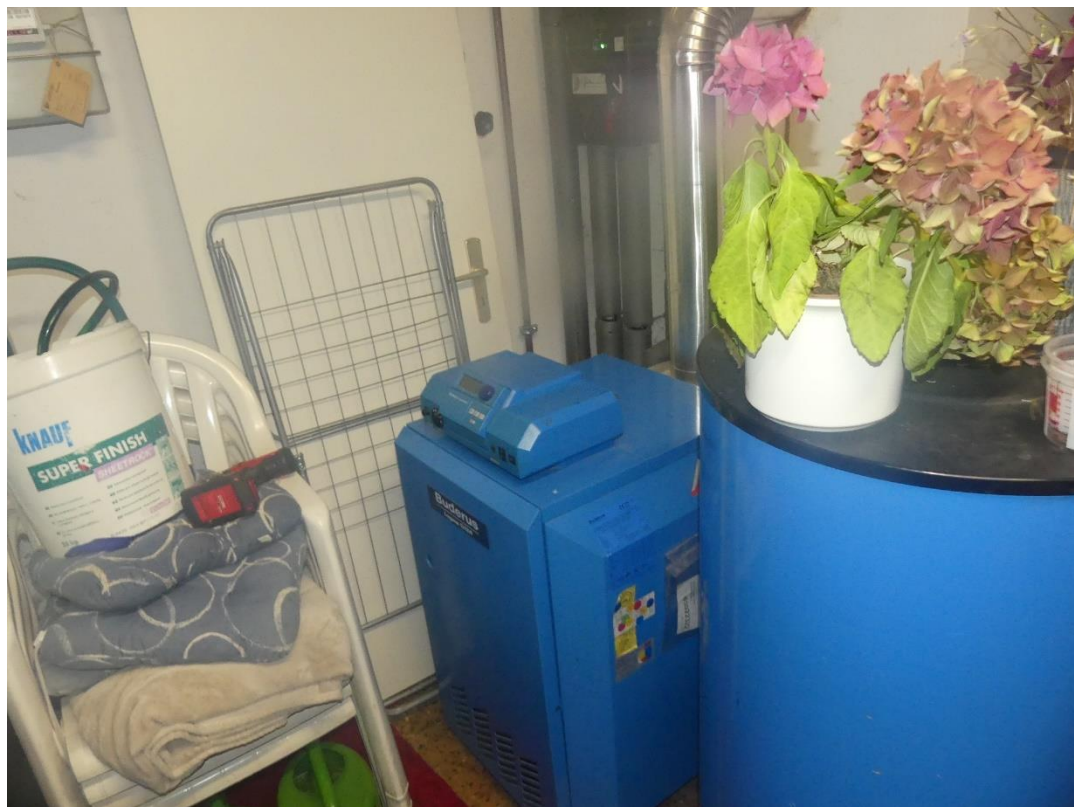
Foto 7: Heizung Döbelner Straße 25
