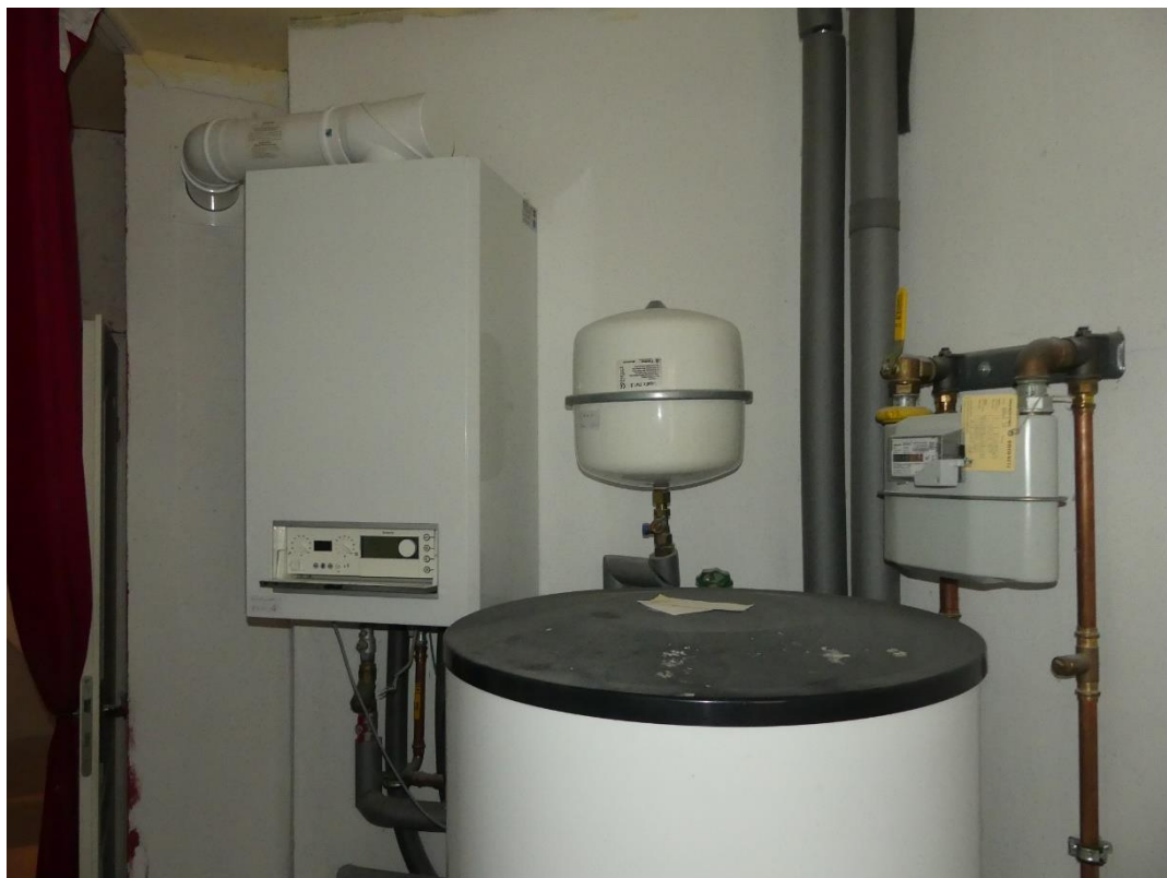
Foto 16: Heizung im Erdgeschoss Döbelner Straße 25a
