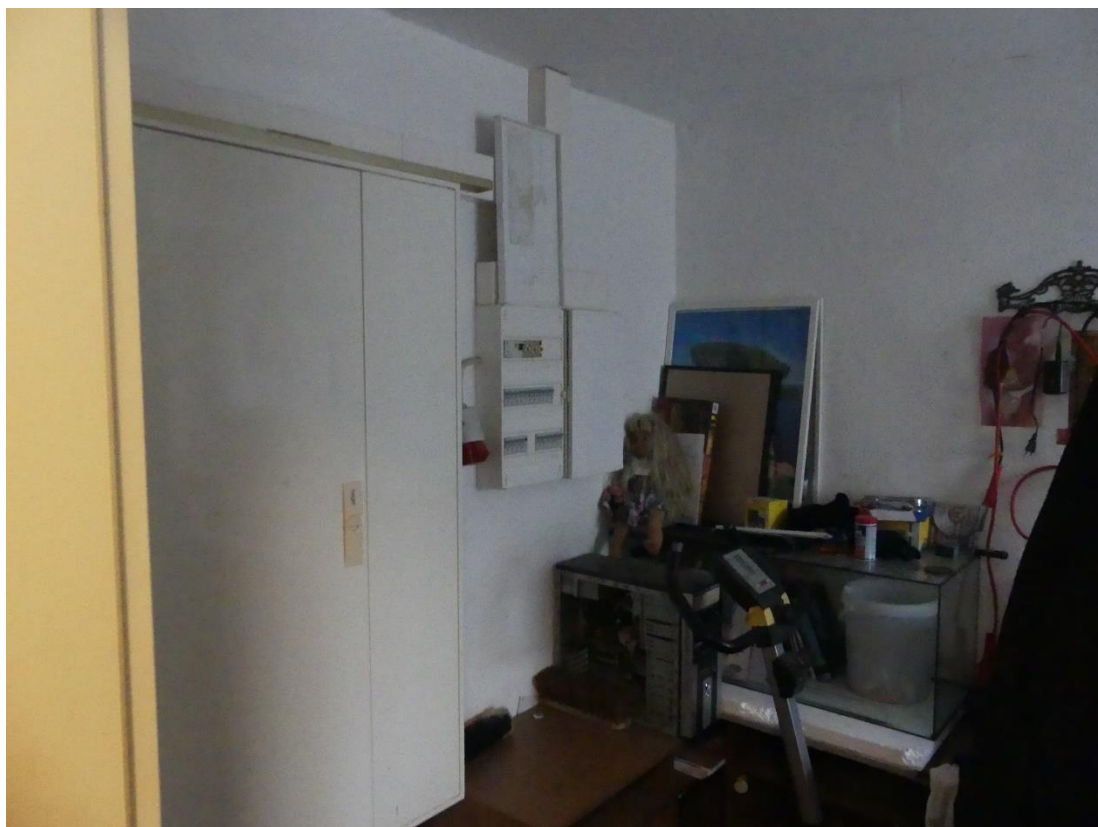
Foto 5: Hausanschlussraum Döbelner Straße 25
