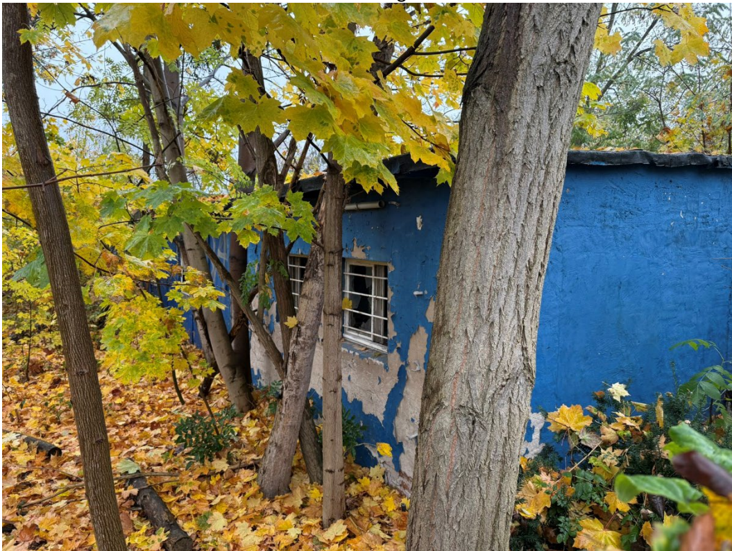
abrissreife Baracke auf dem Wertermittlungsgrundstück
