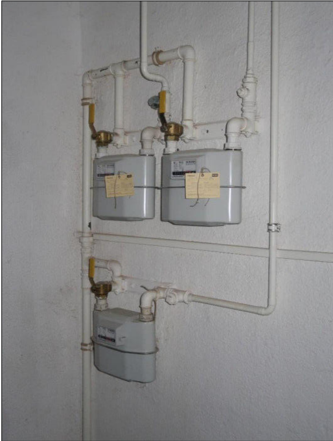
Bild 9: 1.OG, Gemeinschaftseigentum Treppenhaus, Gas-Zähler
