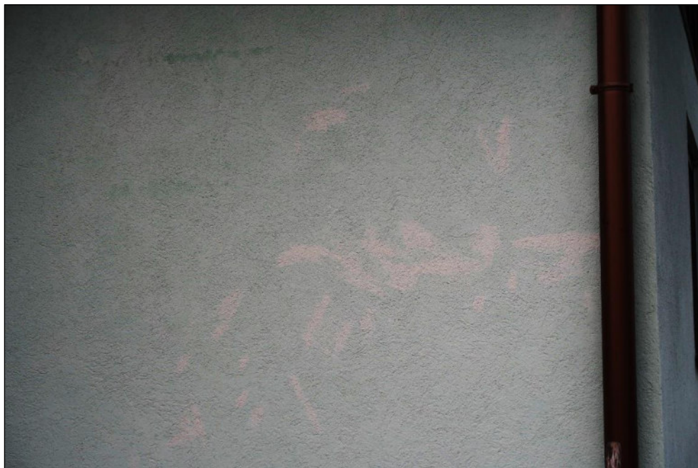
Bild 10: Farbunterschiede im Fassadenanstrich
