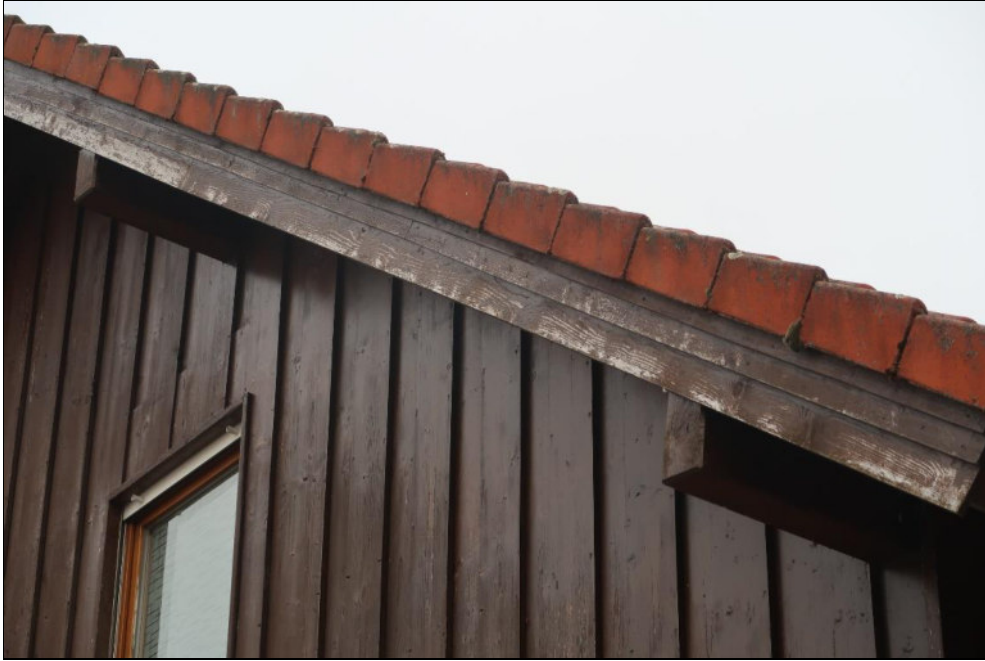
Bild 9: Detailansicht der Dachverkleidung am Ortgang (malermäßige Instandsetzung notwendig)
