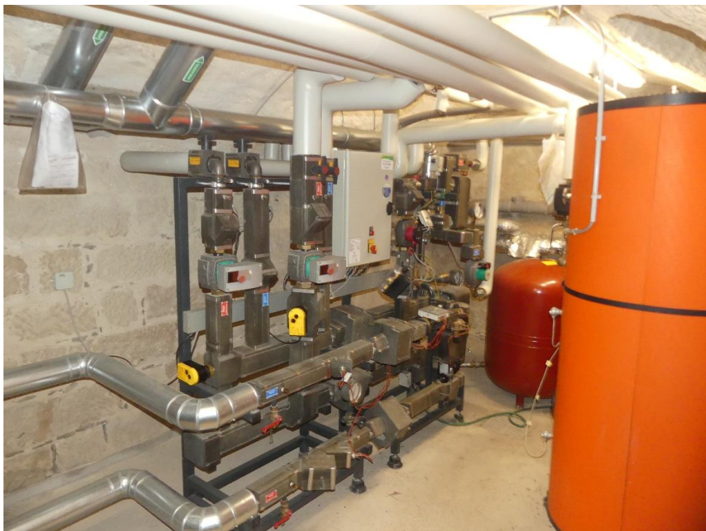
Foto 17: Fernwärmeübergabestation im Keller
