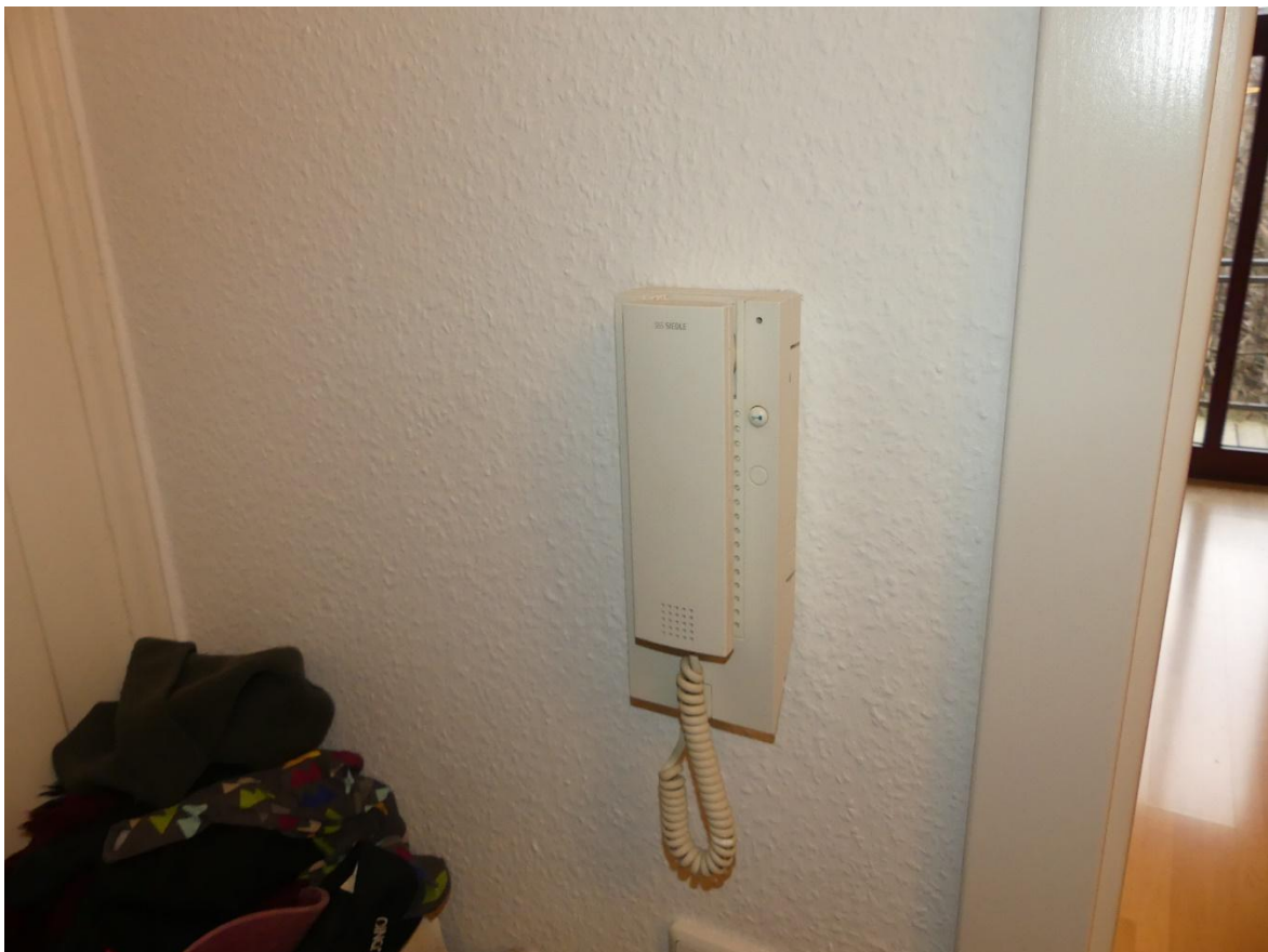
Foto 12: Flur Wg. Nr. 5, Klingel-Wechselsprechanlage
