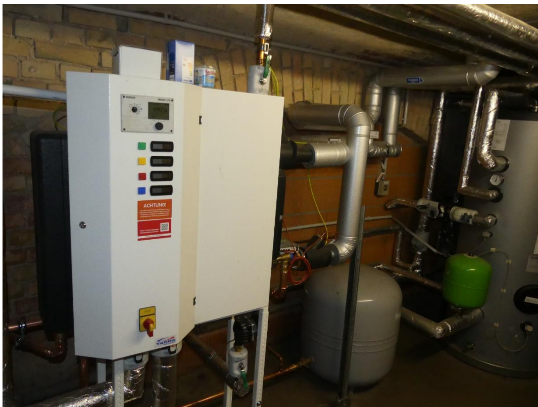
Foto 16: Fernwärmeübergabestation im Keller
