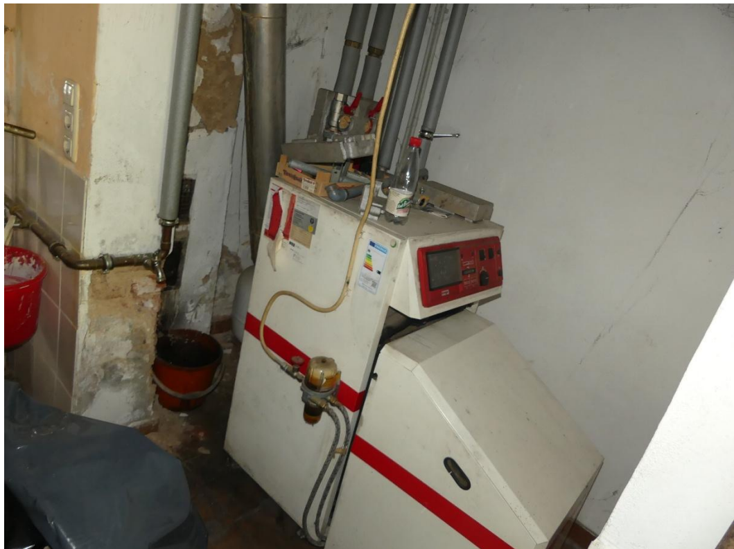
Foto 13: Heizung im ehem. Stallbereich
