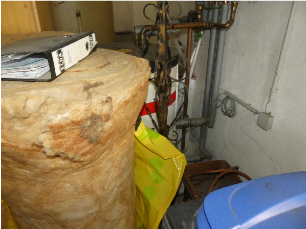
Foto 14: Warmwasserbereiter im ehem. Stallbereich
