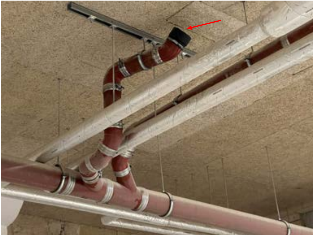
blind endende Abwasserleitung unter der Wohnung Nr. 1
