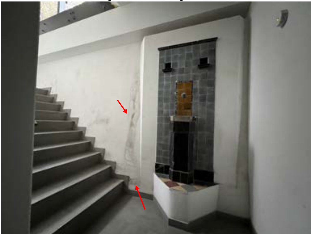
dunkle Verfärbung an Innenwandbereichen (vermutlich infolge unzureichender Lüftung)
