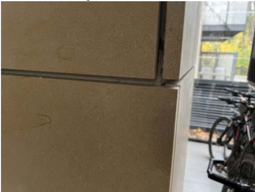
... offene Fugen an Sandsteinverkleidungen
