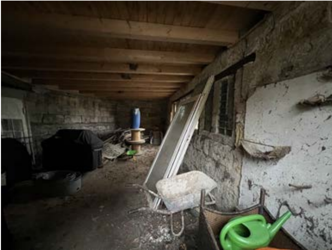
nicht fertiggestellter Fahrradabstellraum
