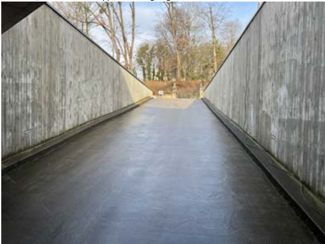
Tiefgaragenzufahrt; Beheizung der Zufahrt nicht angeschlossen
