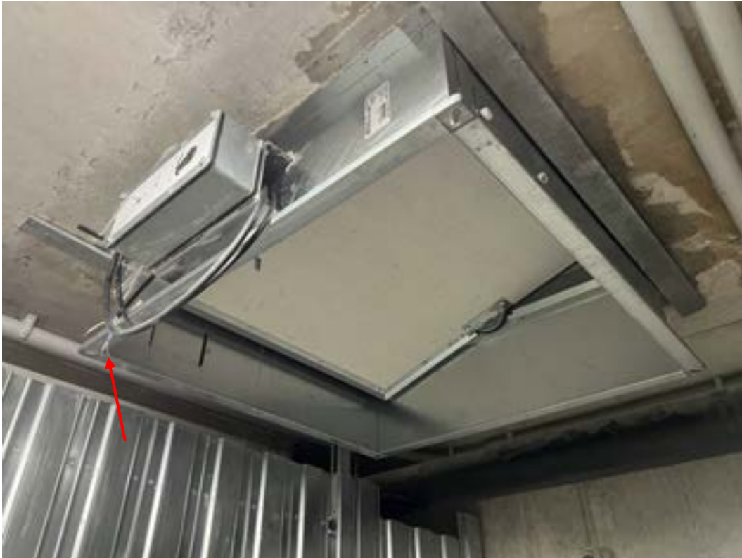
Entlüftung der Kellerräume nicht angeschlossen
