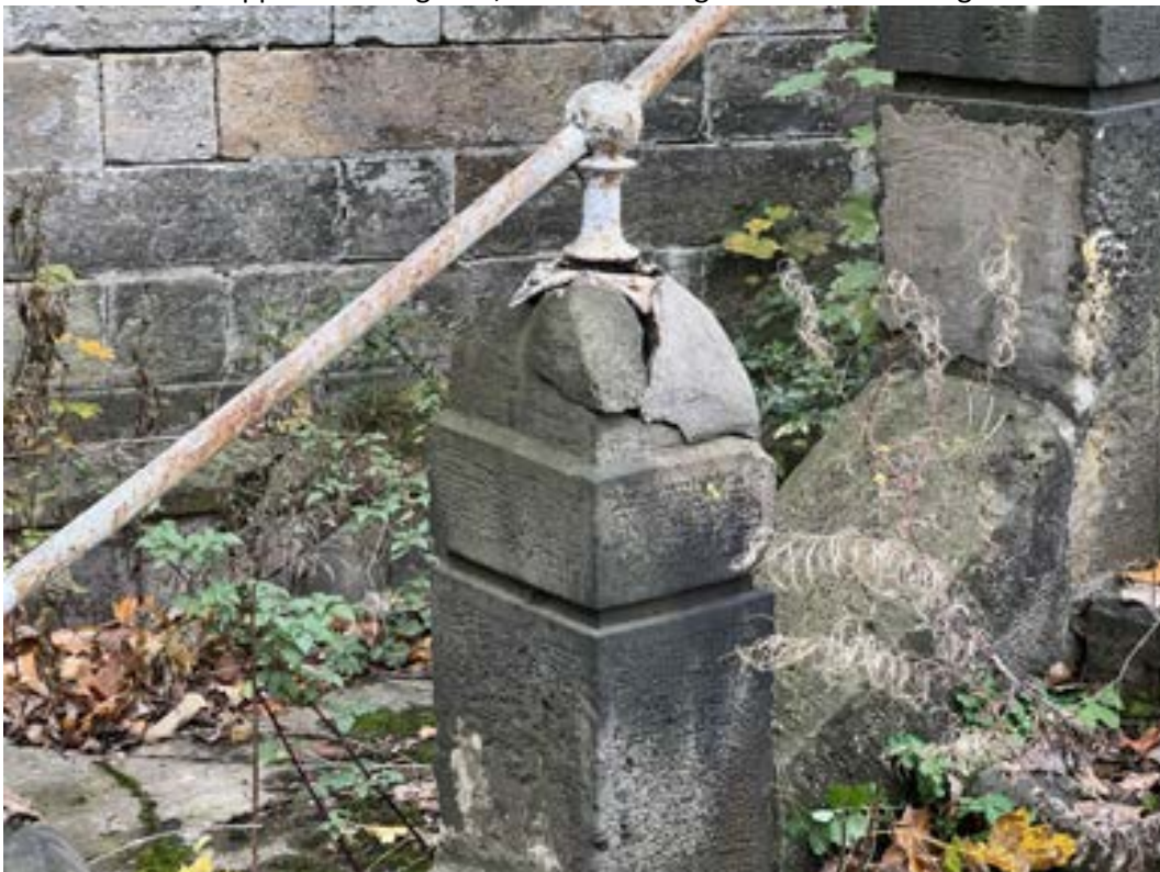
Schäden an der Freitreppe; die Sanierung der Freitreppe obliegt der gesamten Gemeinschaft
