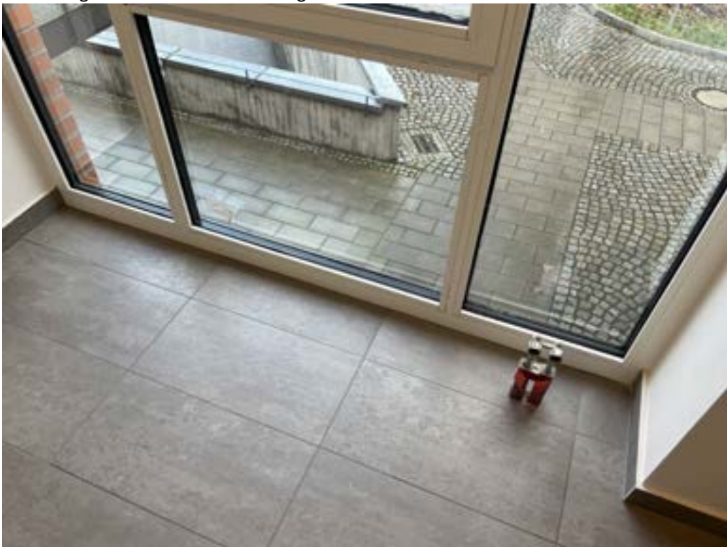
Heizkörper in Treppenhäusern/Gängen wurden nicht montiert
