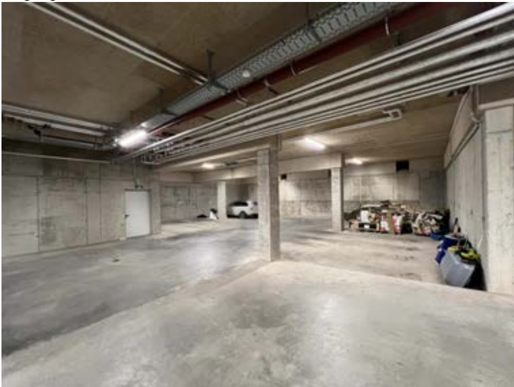
Tiefgarage; die geplanten 12 Doppelparker wurden nicht eingebaut; angeblich wurde die erforderliche Chlorid-Beschichtung des Tiefgaragenbodens auch nicht aufgebracht
