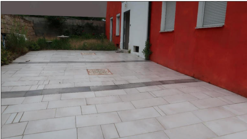
Bild 5: Zugangsbereich zum Treppenhaus mit nicht rutschfestem Fliesenbelag
