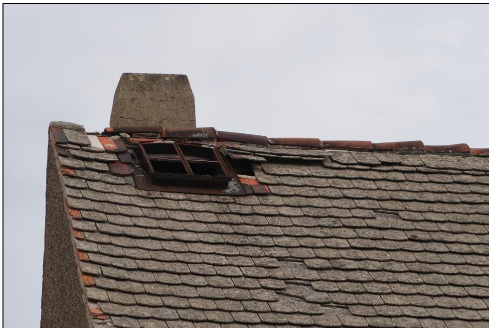
Bild 9: Detailansicht der schadhaften Dacheindeckung des ehem. Wohn- und Geschäftshauses
