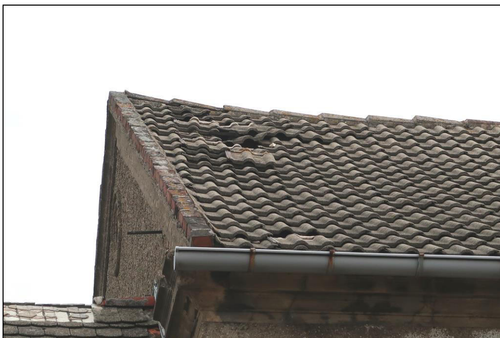
Bild 10: Detailansicht der schadhaften Dacheindeckung des ehem. Wohn- und Geschäftshauses
