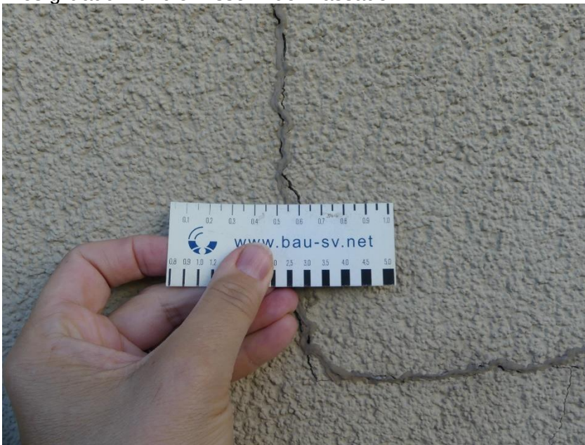
Risse bis 0,8 mm
