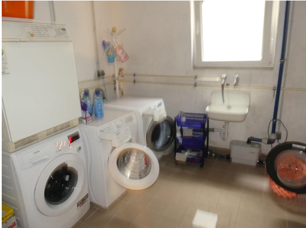
Foto 5: Waschmaschinenraum im Kellergeschoss
