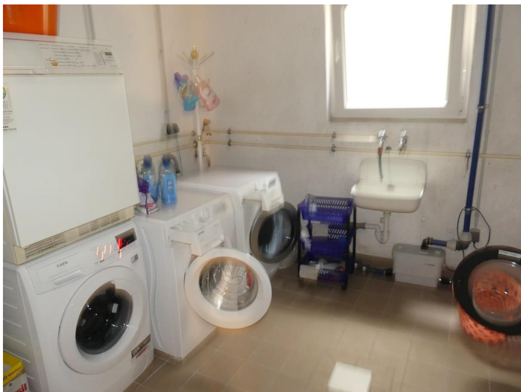
Foto 10: Waschmaschinenraum im Kellergeschoss
