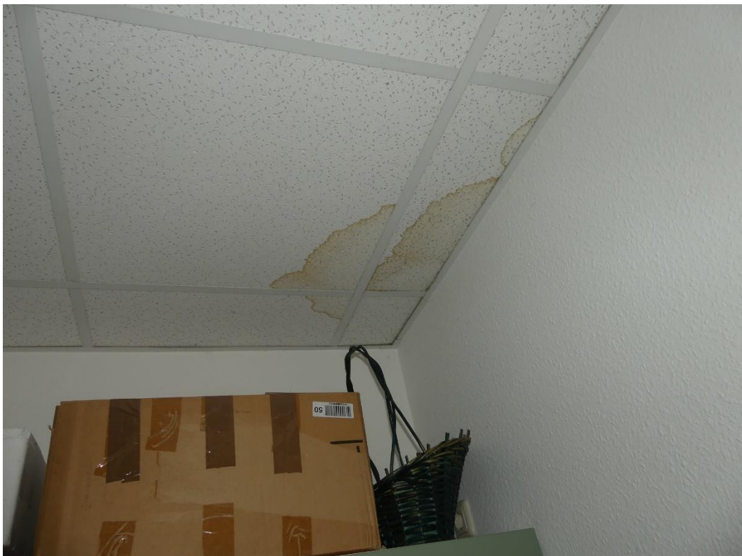
Foto 12: Wasserschaden an der Decke Laden 31
