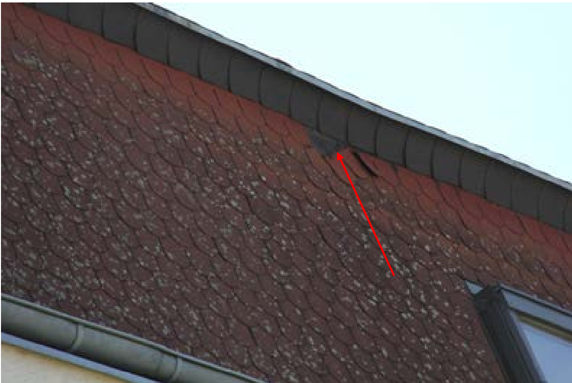
Bitumenschindeln haben sich aus dem Verbund gelöst (Aufnahme aus 2022)
