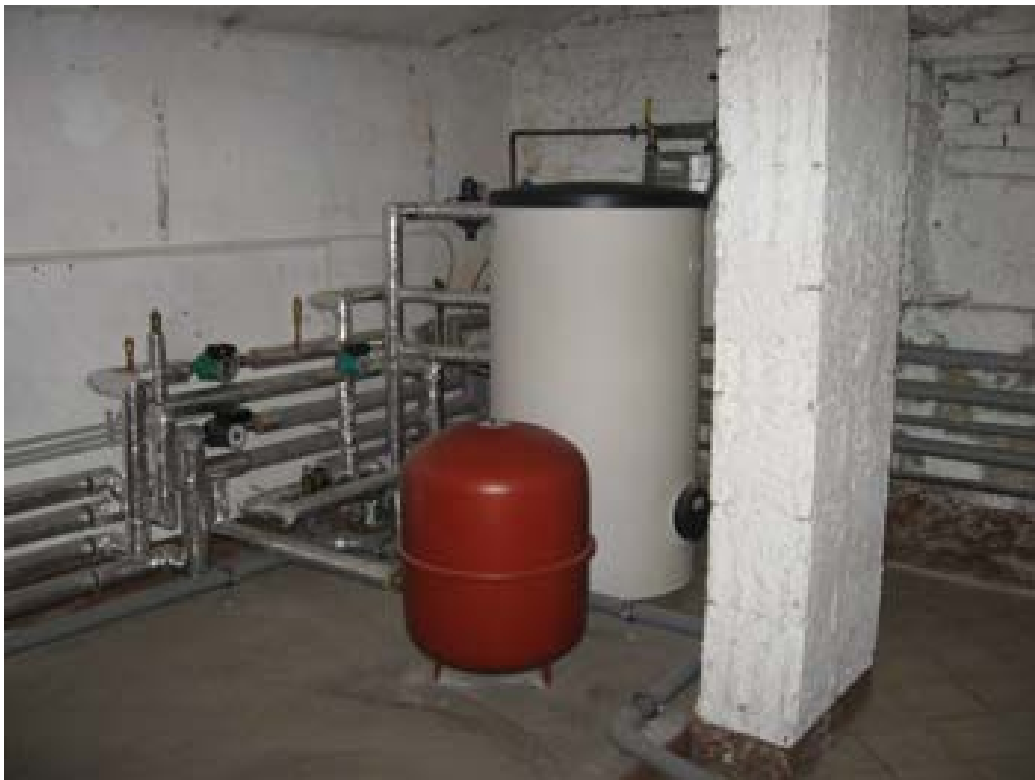
Warmwasserspeicher und Druckausgleichsbehälter (Aufnahme aus 2009)
