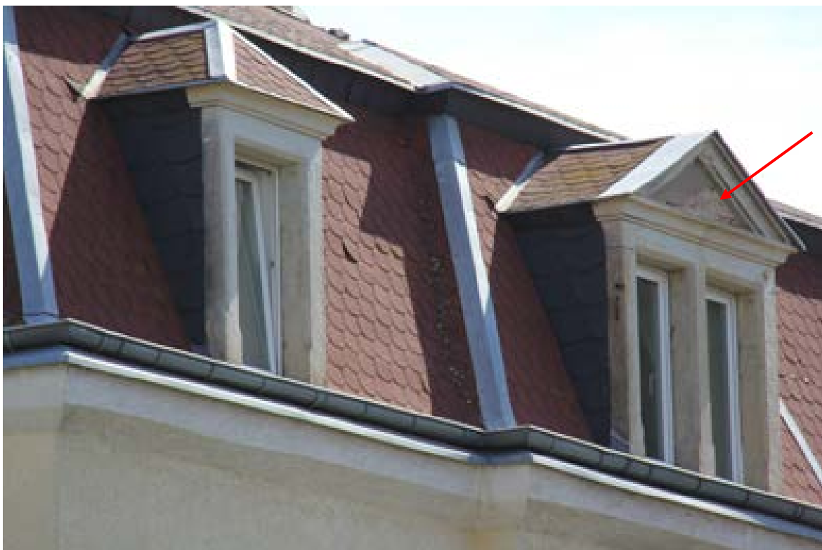
Detail Putzschaden an Gaubengiebel (Aufnahme aus 2022)
