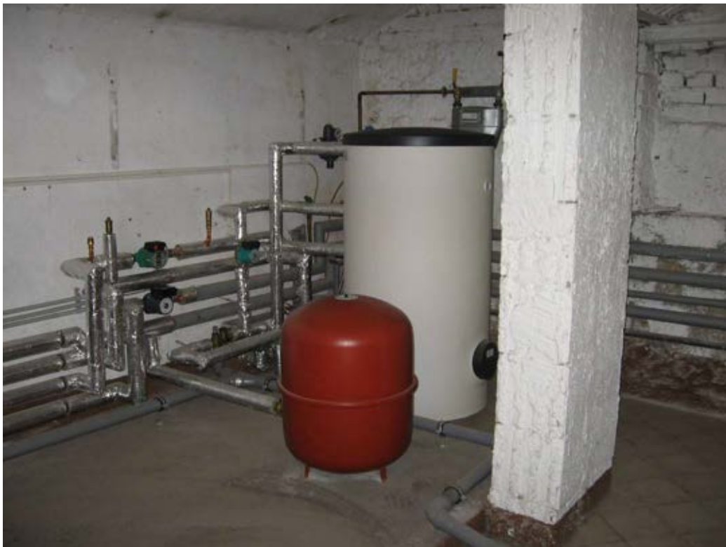
Warmwasserspeicher und Druckausgleichsbehälter (Aufnahme aus 2009)
