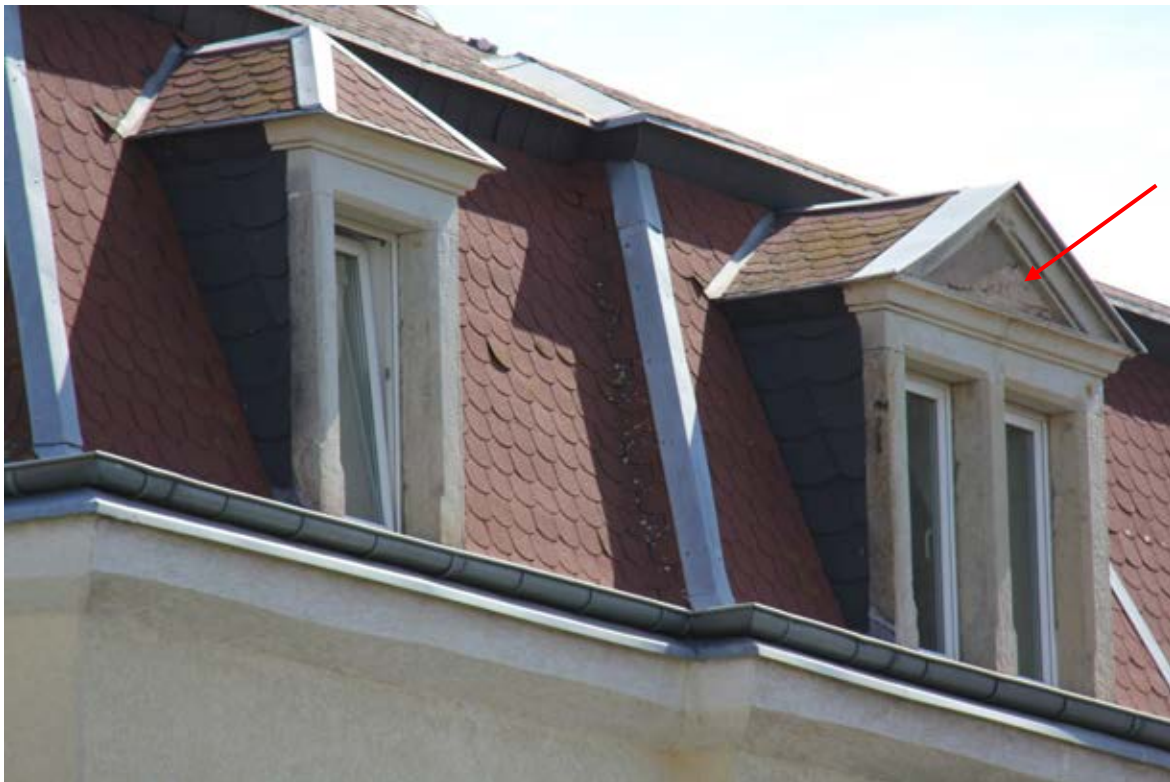
Detail Putzschaden an Gaubengiebel (Aufnahme aus 2022)
