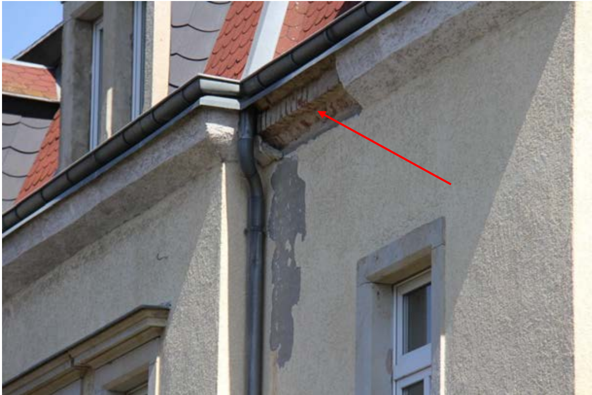
Detail Putzschaden am Fallrohr (Aufnahme aus 2022)
