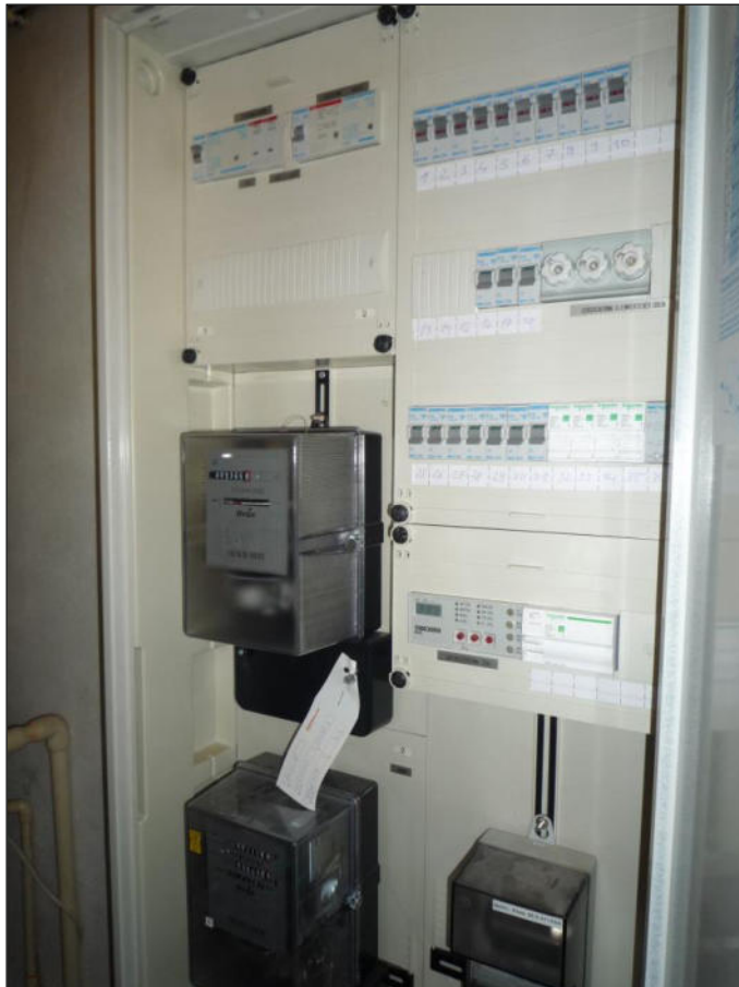
Bild 24: Wohnhausanteil, EG, Elt-Hauptverteilung
