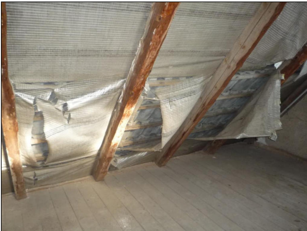
Bild 34: Wohnhausanteil, Spitzboden, zerschlissene Unterspannbahn
