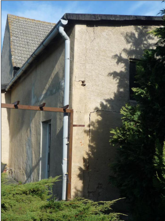
Bild 13: Rissbildungen im Außenmauerwerk des Geräteschuppenanbaus
