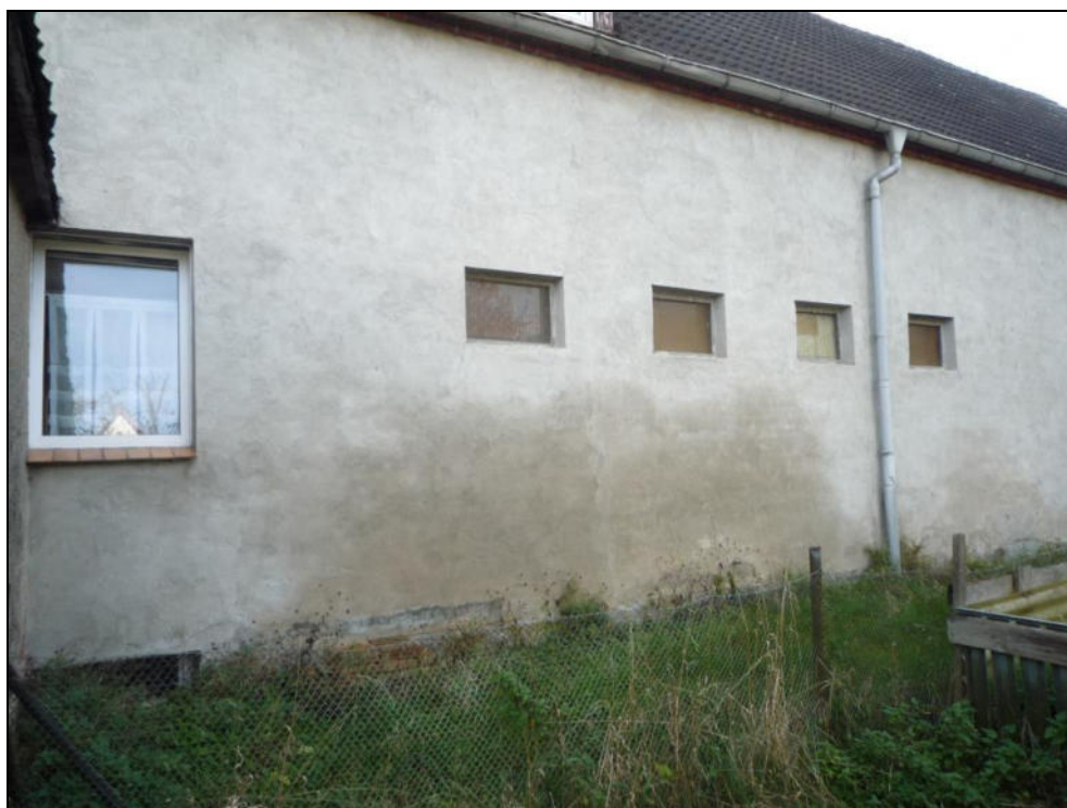
Bild 10: sichtbare aufsteigene Feuchtigkeit, nördliche Gebäudeseite des ehem. Stallanteils
