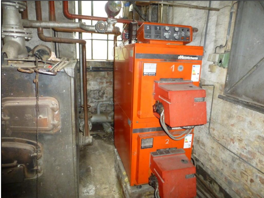
Foto 6 Innenansicht Wohnhaus und Anbauten – Heizung (EG)
