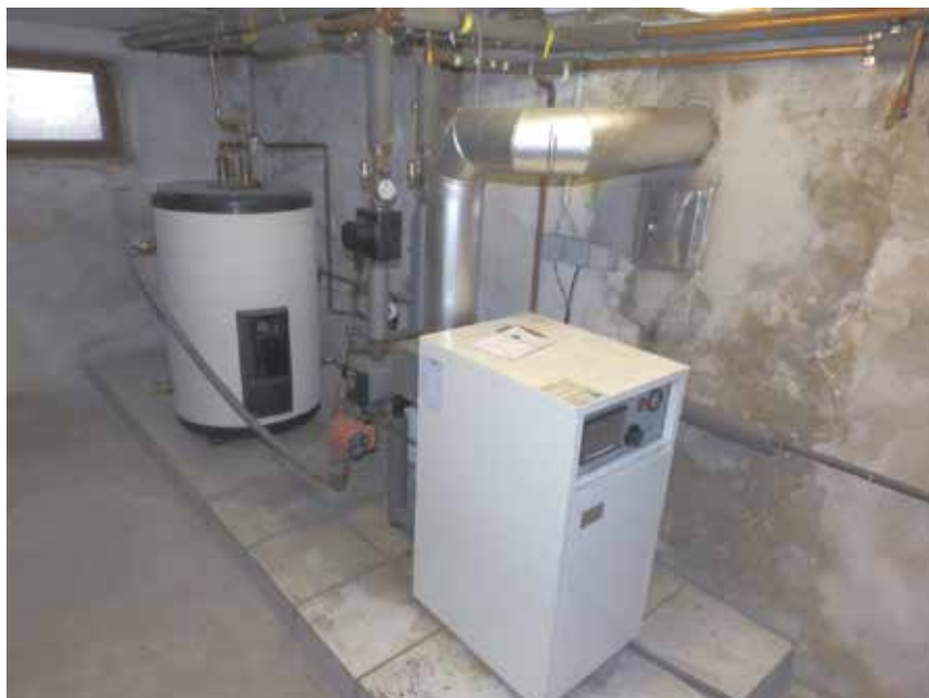
Bild 10: Kellerraum, mit Heizung
