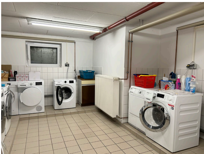
Abb. 16 Kellergeschoss, Teilansicht Waschmaschinenraum im Haus Nr. 37
