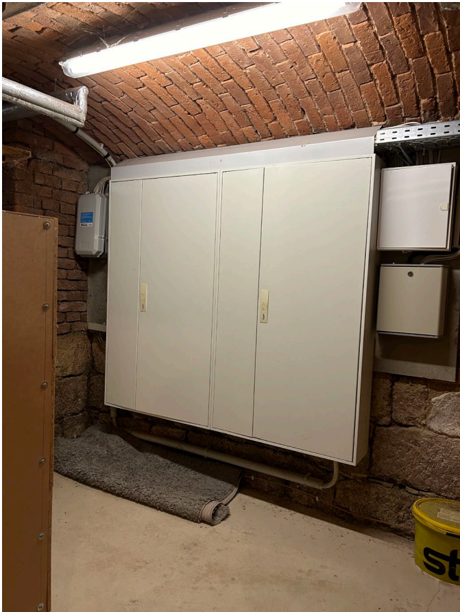
Abb. 10 Kellergeschoss, Teilansicht elektrotechnische Anlagen
