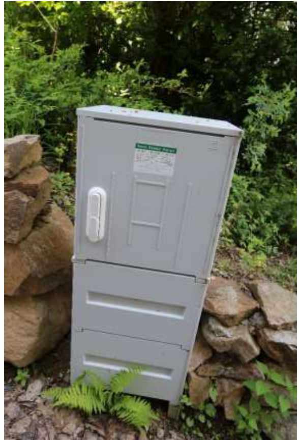
Schaltkasten für vollbiologische Kläranlage
