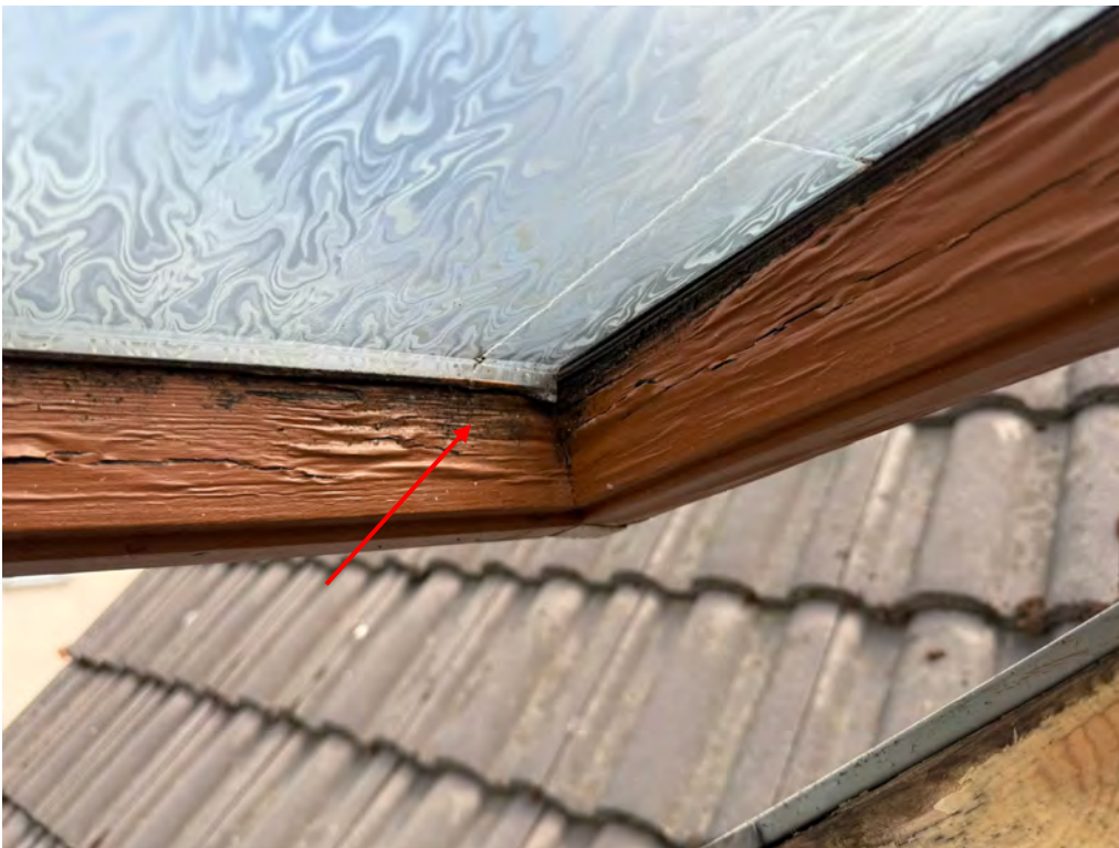
Zustand der insgesamt 3 Dachflächenfenster (morsche Holzrahmen, beginnende Fäulnis)
