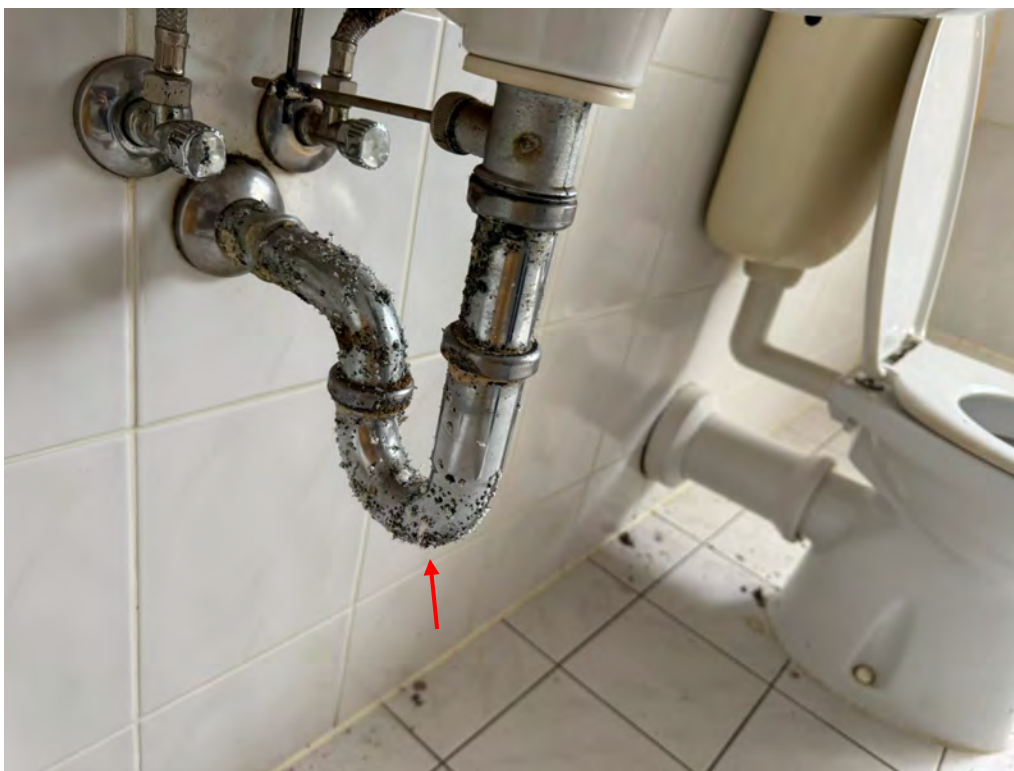
Wohnung Nr. 10 – Zustand der Sanitäranlage
