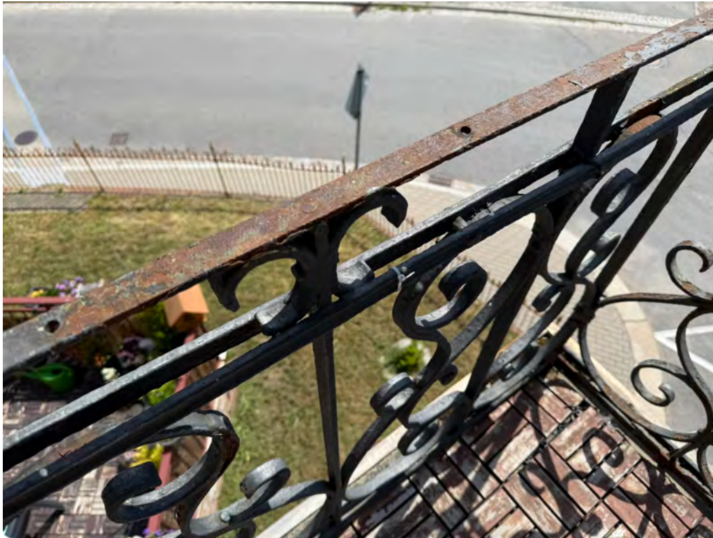
Wohnung Nr. 4 – verrostetes Balkongeländer (Rostschutz erforderlich)
