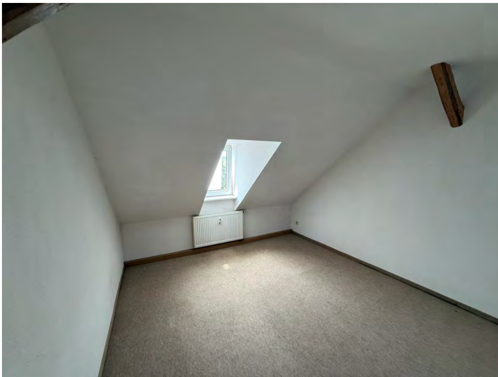
Wohnung Nr. 10 – Zimmer 2 (Bodenbeläge abgewohnt)
