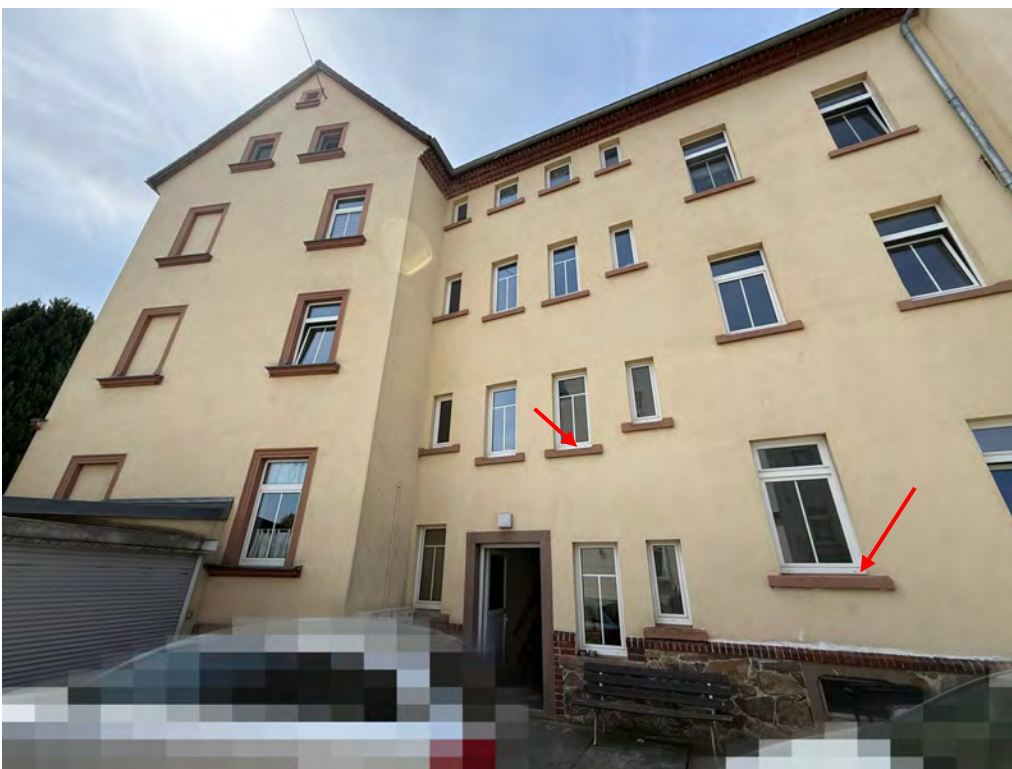
Gebäuderückseite; hier fehlen überwiegend die Außenfensterbänke
