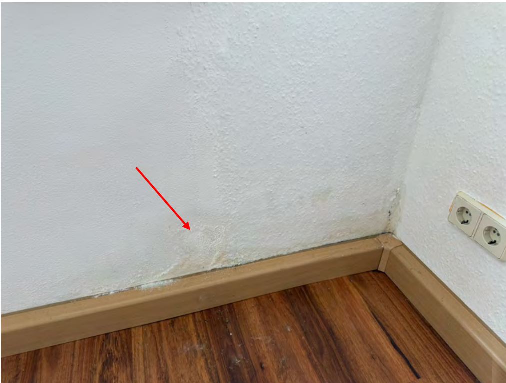
Wohnung Nr. 1 – Ausblühungen im Sockelwandbereich (Zimmer 2)
