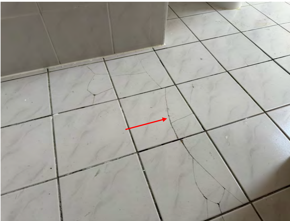
Wohnung Nr. 11 – Risse im Fliesenboden im Bad
