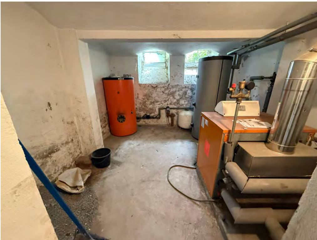
Heizraum im Kellergeschoss mit Gaszentralheizung (von 1996), WW-Speicher von 2013 (silber) und einem ausrangierten WW-Speicher (Orange)
