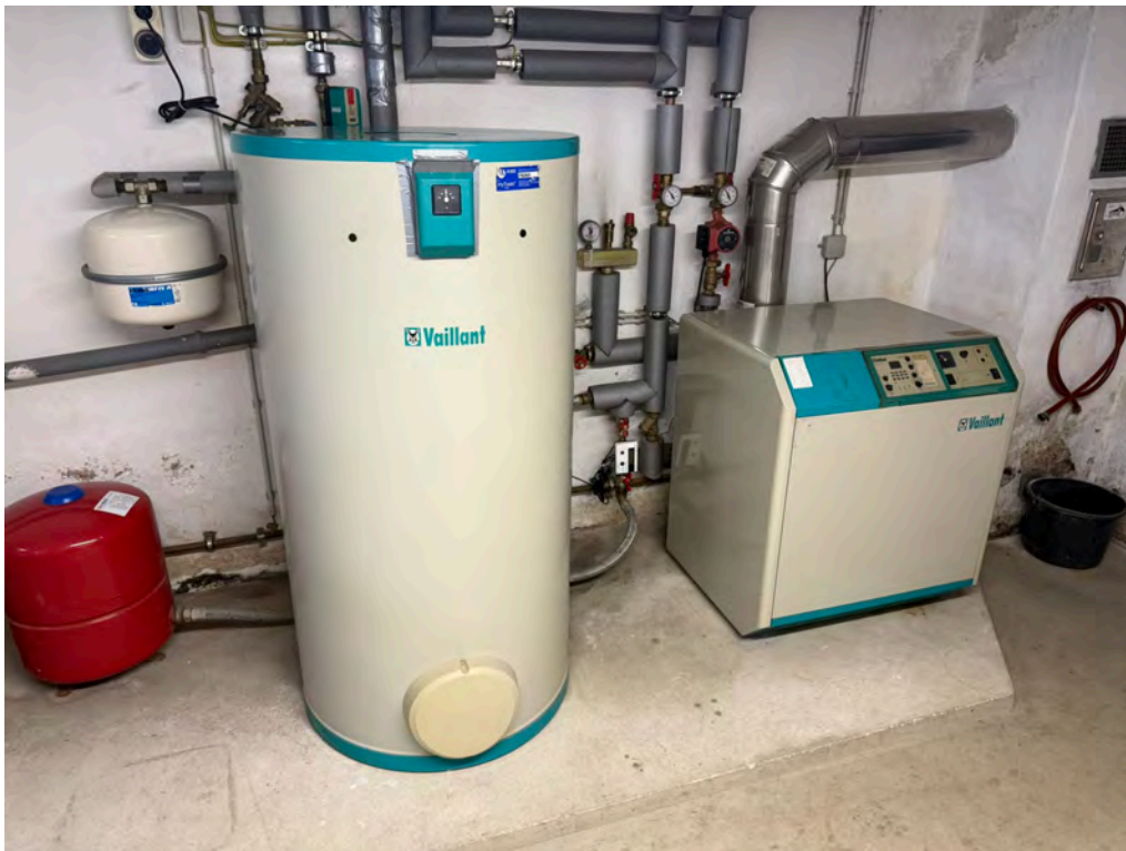
Heizanlage von Vaillant im Kellergeschoss
