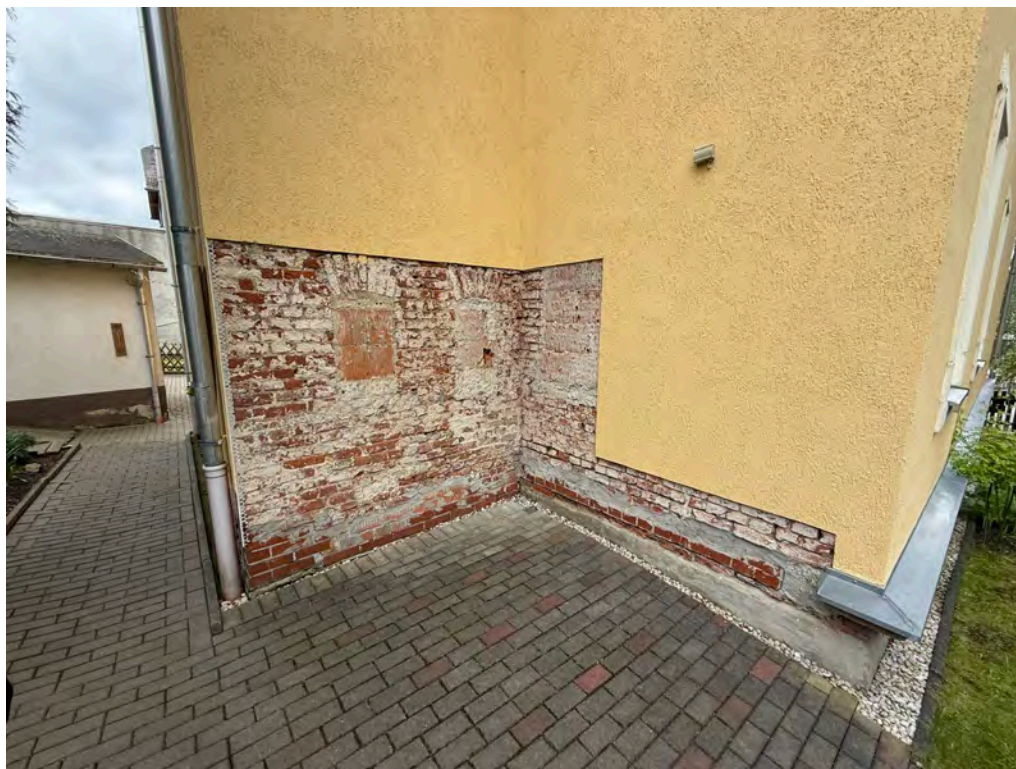
unverputzte Fassadenbereichen auf der Gebäuderückseite
