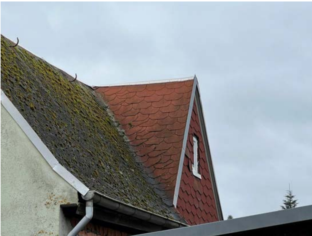
nördliche Dachfläche mit erheblicher Vermoosung
