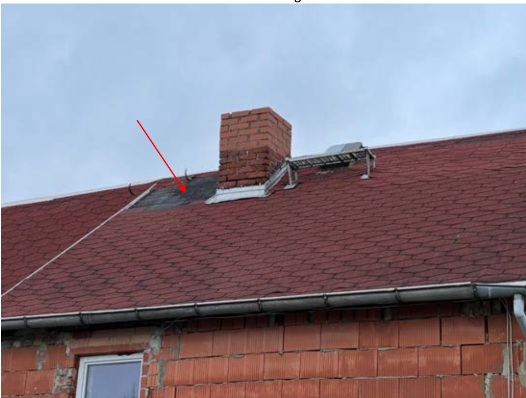
Westseite des Daches mit einem Dachschaden (Pfeil)
