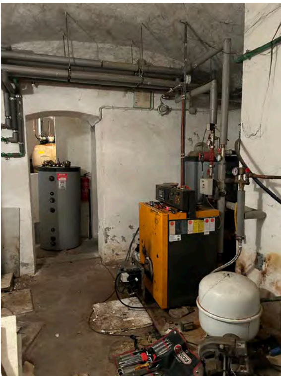
Abb. 14 Kellergeschoss, Teilansicht der Öl-Heizungsanlage
