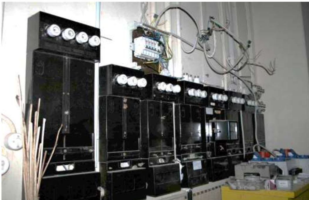
Innenansicht Villa elektrische Anlage
