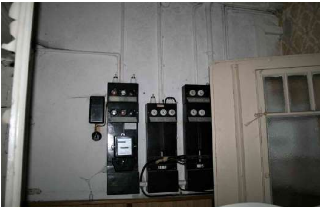
Innenansicht MFH elektrische Anlage
