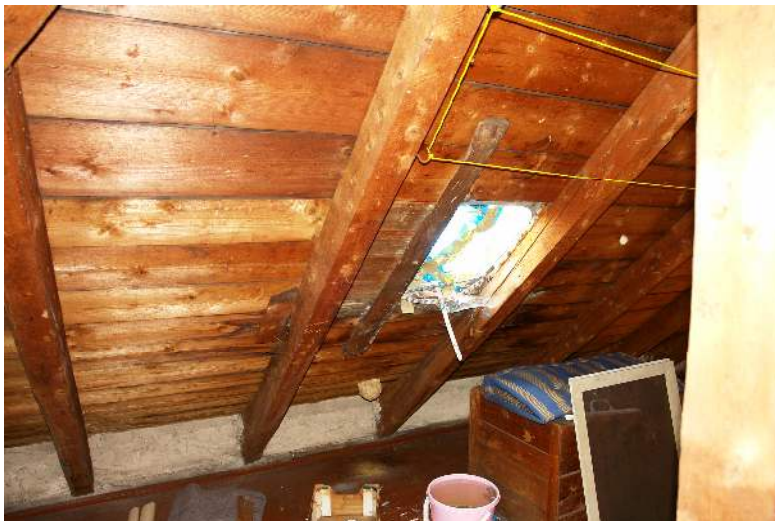
Bild 44: Wassereimer unter Dachfenster
