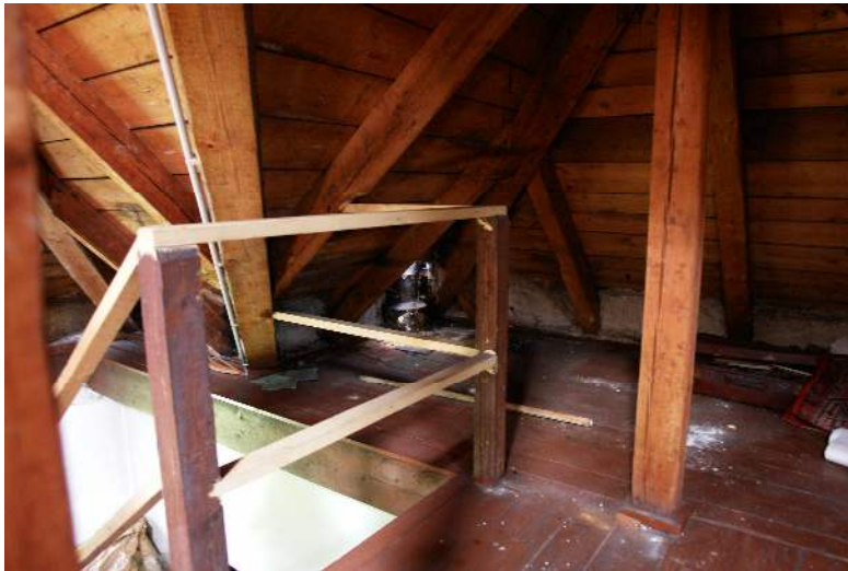
Bild 43: Lichteinfall an Durchführung Entlüftungsrohr TC
