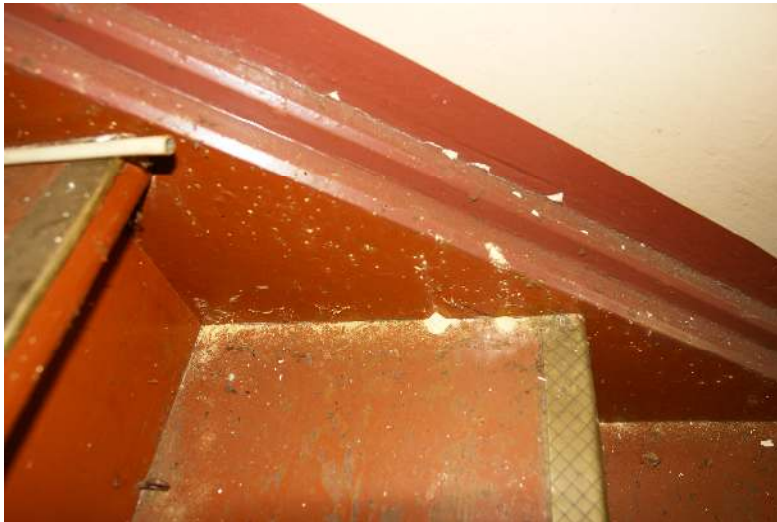
Bild 31: Holzwurmbefall hölzerne Geschosstreppe EG - OG
