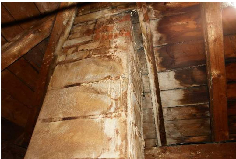
Bild 45: Durchführung Schornsteine defekt
