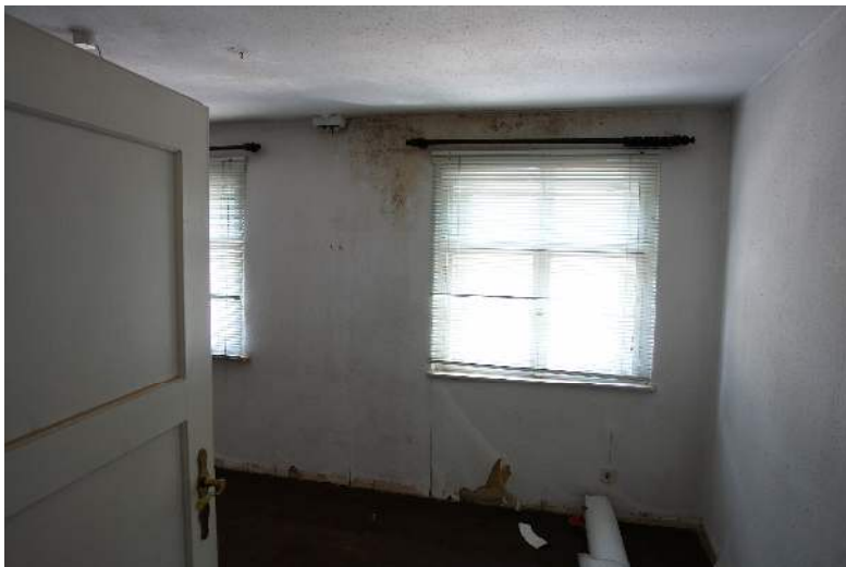
Bild 38: Wohnen OG, Einregnung ausgehend vom DG
