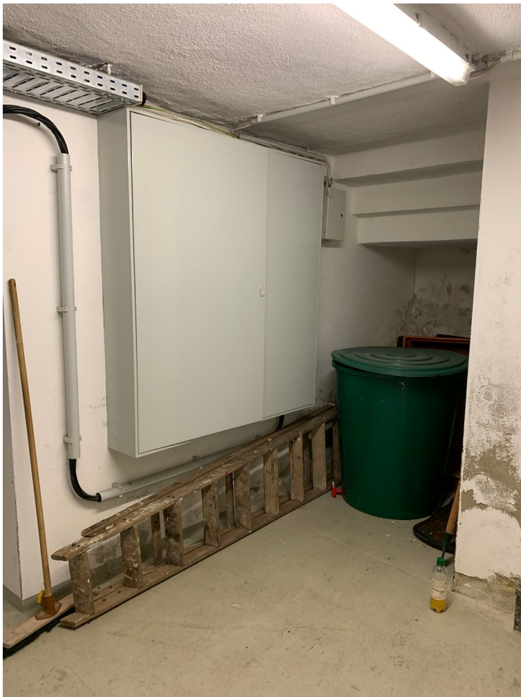
Abb. 12 Teilansicht Kellergeschoss mit Anordnung des Zählerschranks
