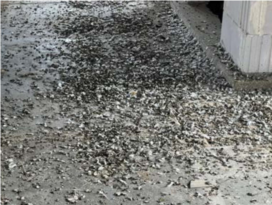
Taubenkot im Dachgeschoss
