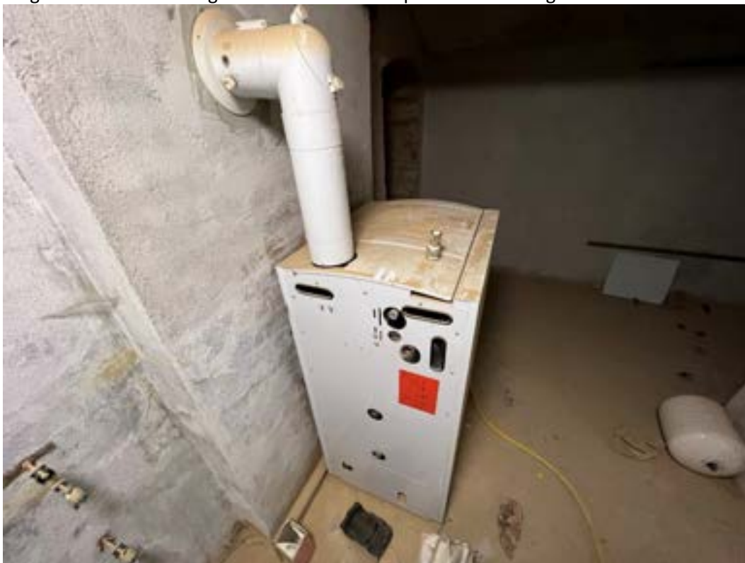
die Heizanlage ist noch nicht angeschlossen
