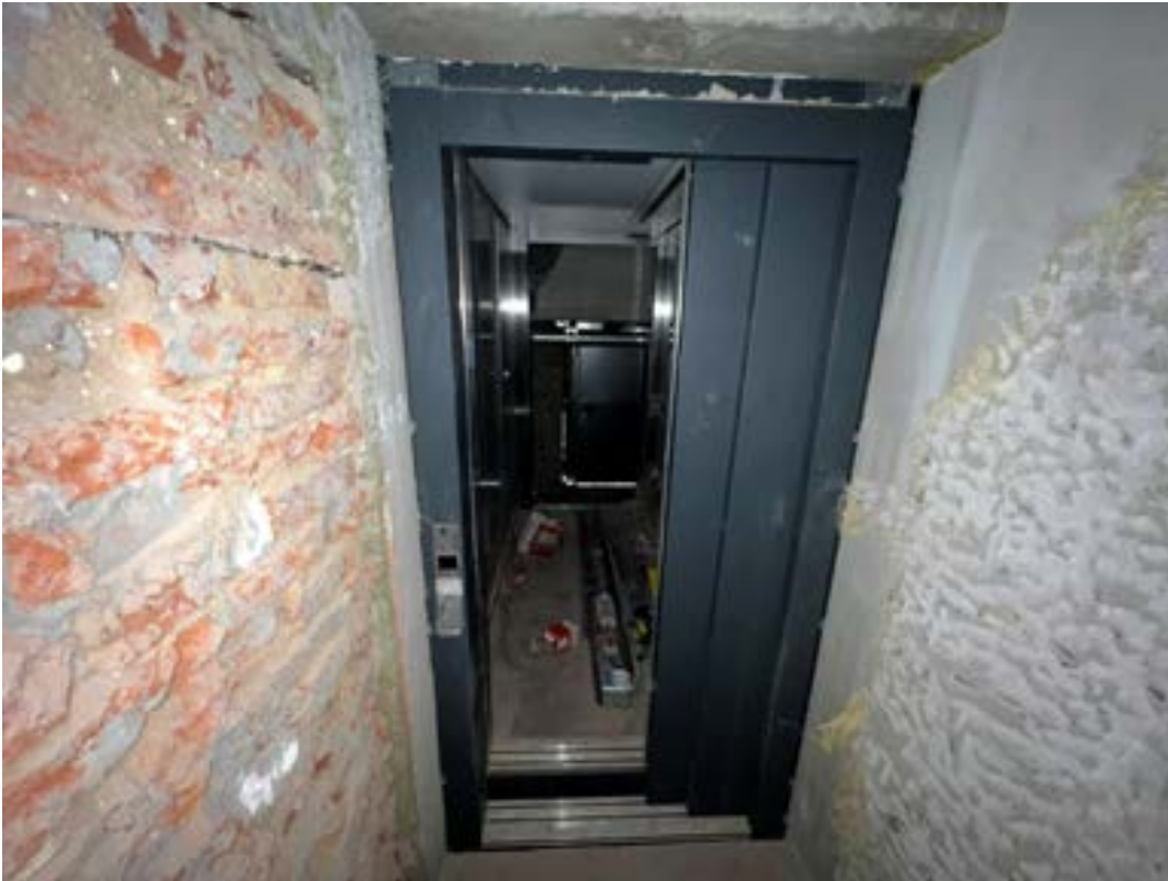
Aufzugskabine (Haltepunkt derzeit im Kellergeschoss)
