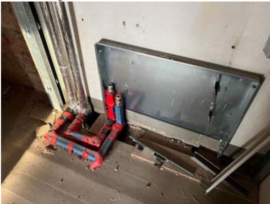
Steigleitungen und Anschlüsse für Heizung
