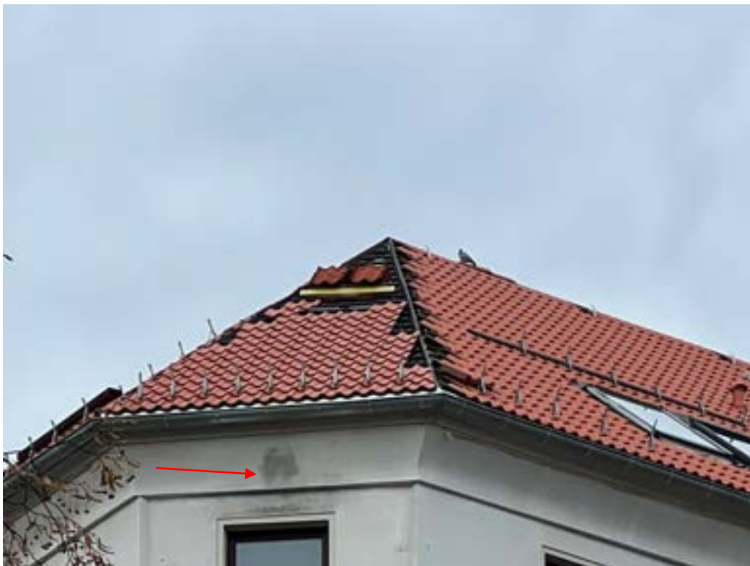
Dacheindeckung nicht fertig gestellt; dadurch vermutlich Durchfeuchtung an Außenwand (Pfeil)
